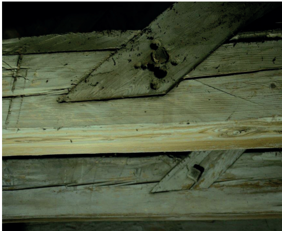
Spår av mallbygge, flera genomborrningar i knutar på en av takstolarna i Hossmo kyrkas långhus.
