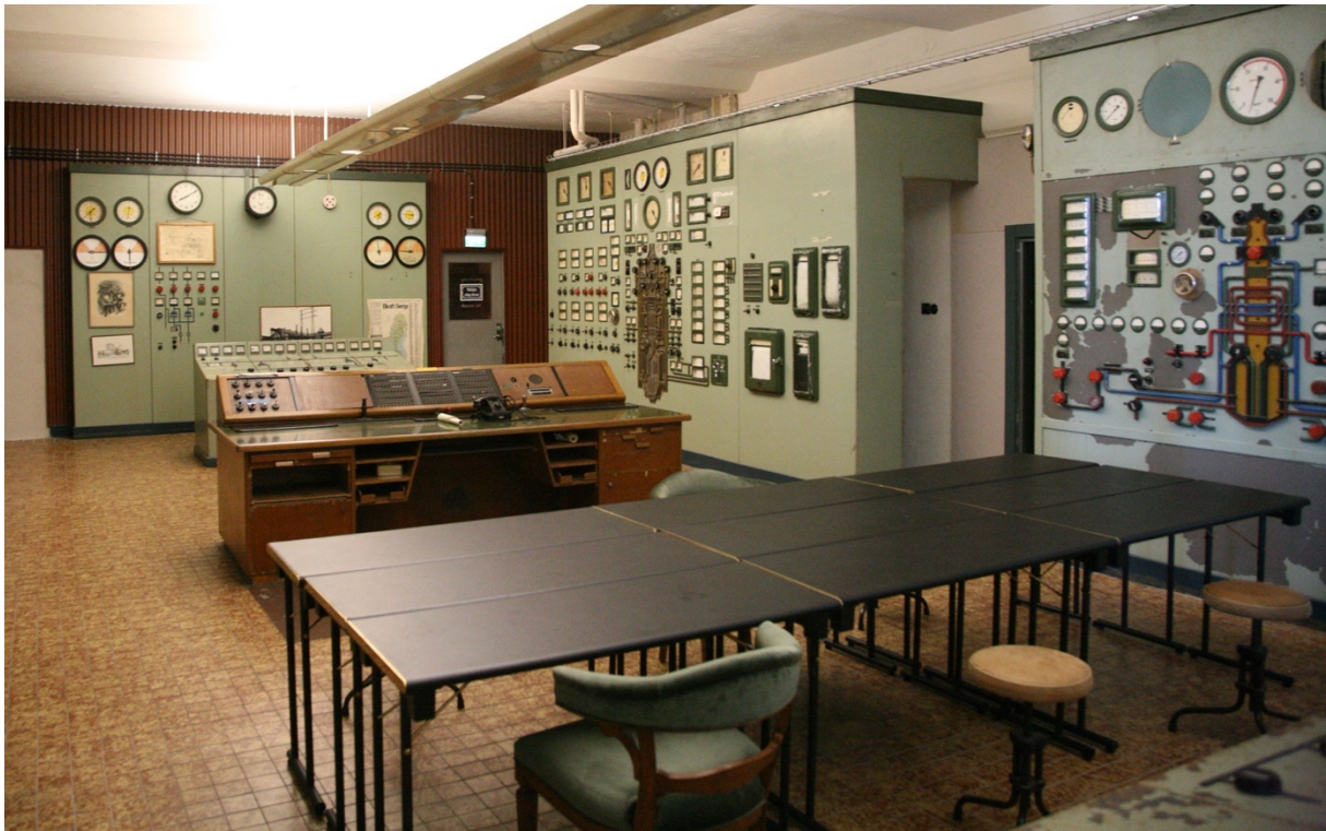
Figur V:06. Ångkraftverket som det ser ut i dag. Kontrollrummet är en av de interiörer som är skyddad i byggnadsminnet och har sparats. Fotograf Camilla Häggman 2022.
