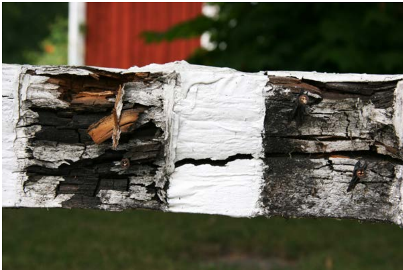
Brunröta (krympningsröta) i en staketregel.
