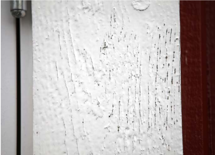
Målar man på blånadsskadat virke som används i utomhusmiljöer, som här i ett fönsterfoder, växer blånadsvampen genom färgskiktet efter några år.
