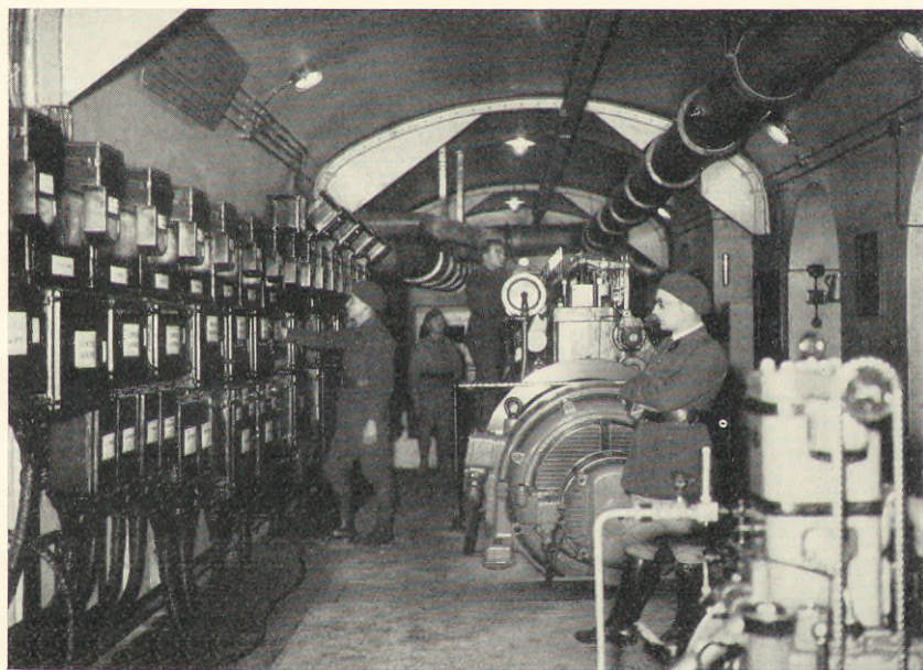
Elverk fyrtio meter under jordytan.
