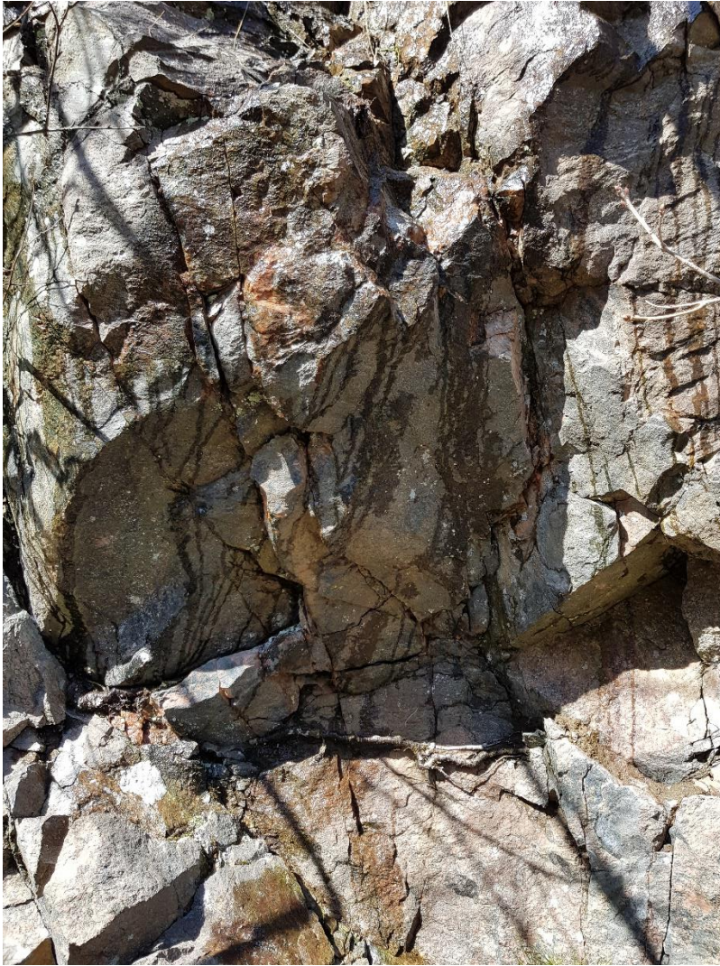
Figur 15: En uppsprucken sektion av Åseberget. Sprickorna är vattenförande.
