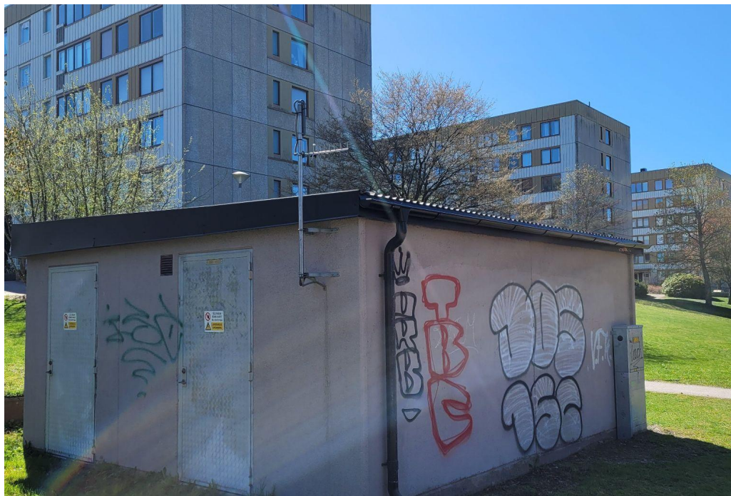
Bild 5. Ett av många exempel på synlig skadegörelse i området. Källa: Hugo Egnell.
