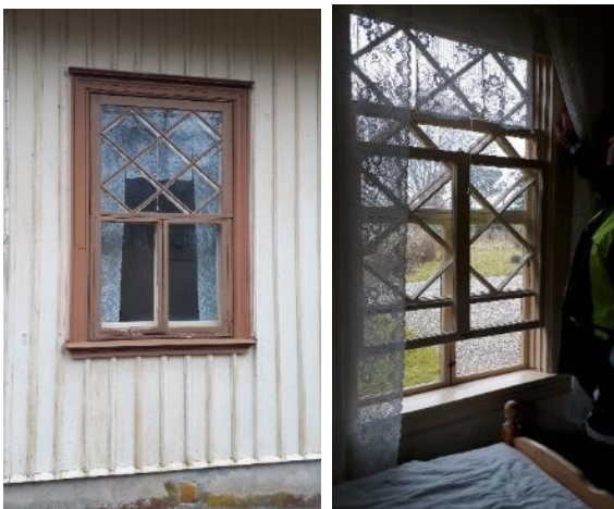
Sash-windows med den yttre vinterbågen isatt. Motvikter sitter bakom fönsterfodren på insidan. Foto MOW 2020.
