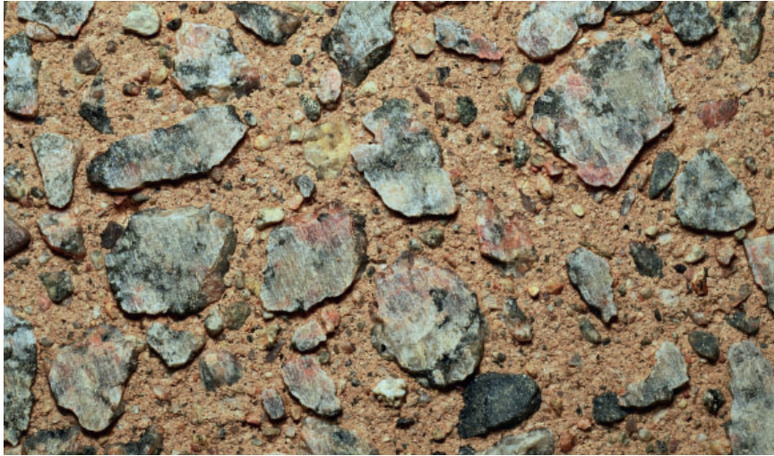
Figur 3.28. Betongyta efter syraangrepp. Den första millimeter av bindemedlet har lösts upp och skapade då friliggande ballastkorn (bildbredd 50 mm). Foto: Urs Müller.
