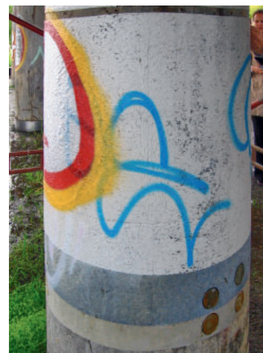
Figur 8.20. Pelare under Elgeseter bro i Trondheim i Norge. Glasfiberarmerad polymerinklädnad runt en bropelare. Pelarna var påverkade av ASR och förstärkningen utfördes med GFRP-inklädnad. Foto: Urs Müller.
