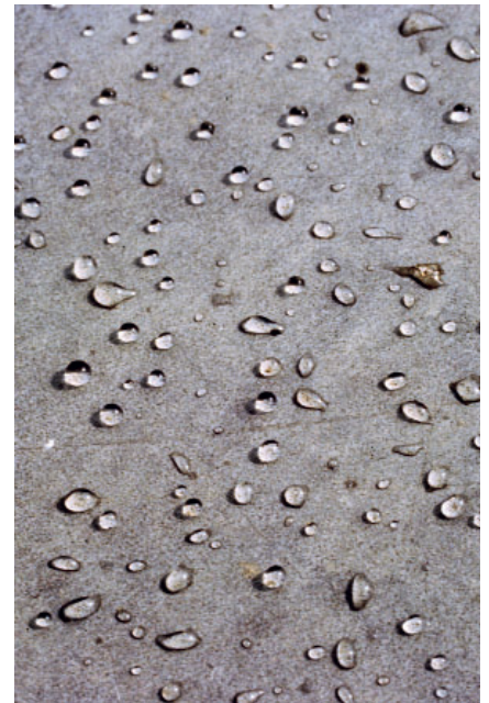
Figur 8.9a & b. På Holocaust Memorial i Berlin har betongytorna behandlats med en hydrofobisk impregnering för att göra ytan vattenavvisande. Foto: Urs Müller.
