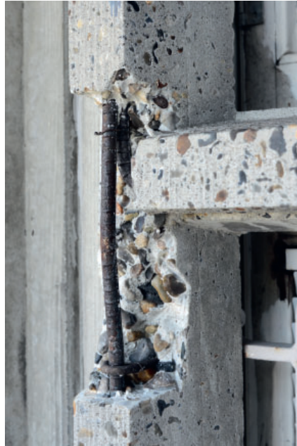
Borttagen betong med rengjord armering. Lägg märke till den nästan vertikala kanten.
