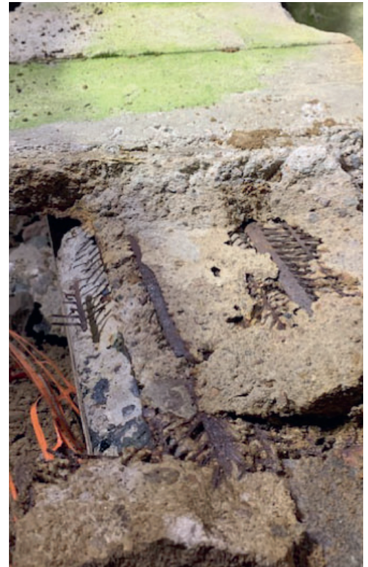
Figur 2.16. Till höger: En armerad betongplatta som rivits bort från en liten gångport under Frykenbanan strax söder om Sunne. Bilden visar Kahn-järn som exponerats under rivningsarbetet. Vingarna på armeringsstångerna påminner om en ryggradsliknande lämning från ett forntida djur. Foto: Trafikverket, 2021.
