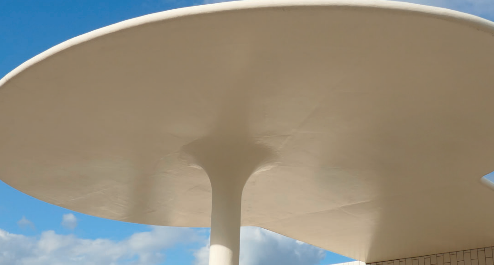
Figur 4.25. Bensinstationens tak efter rekonstruktion. Pelaren är original medan taket göts nytt. I stället för en gjutform av korta formbrädor göts det nya taket mot stora släta skivor. Berättelsen om den ursprungliga gjutformen utseende raderades. Foto: Lone-Pia Bach, 2015.
