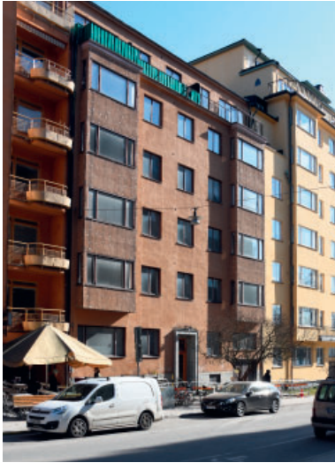
Figur 2.30. Bygganden på John Ericssonsgatan på Kungsholmen i Stockholm är uppförd med en stomme av betong gjord på aluminatcement. Skicket är så dåligt att fastighetsägaren har tomställt huset och önskar riva byggnaden. Till vänster i bild syns en rad balkonger på det byggnadsminnesmärkta kollektivhuset ritat av Sven Markelius 1935. Foto: Sven Olof Ahlberg, 2022.
