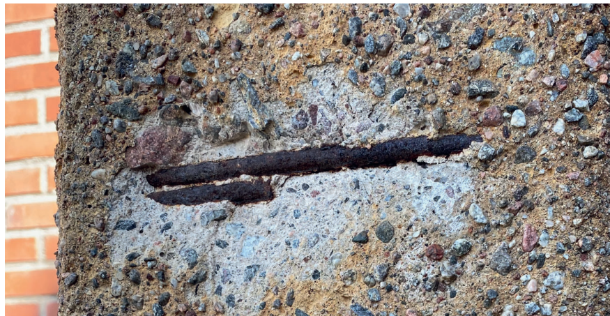
Figur 5.13. Betongskada orsakad av korroderande armering som expanderat. Detta är en av de vanligaste skadetyperna hos äldre betongkonstruktioner med ytligt liggande armering. Foto: Sven Olof Ahlberg, 2021.
