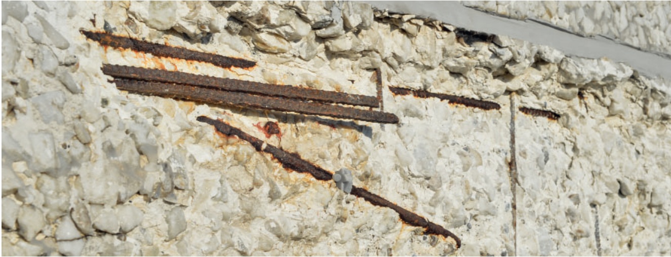
Figur 7.22. Korrosion på ett förtillverkat väggelement i ett flervåningshus tillhörande BRF Tantolunden, Stockholm. Foto: Sven Olof Ahlberg.
