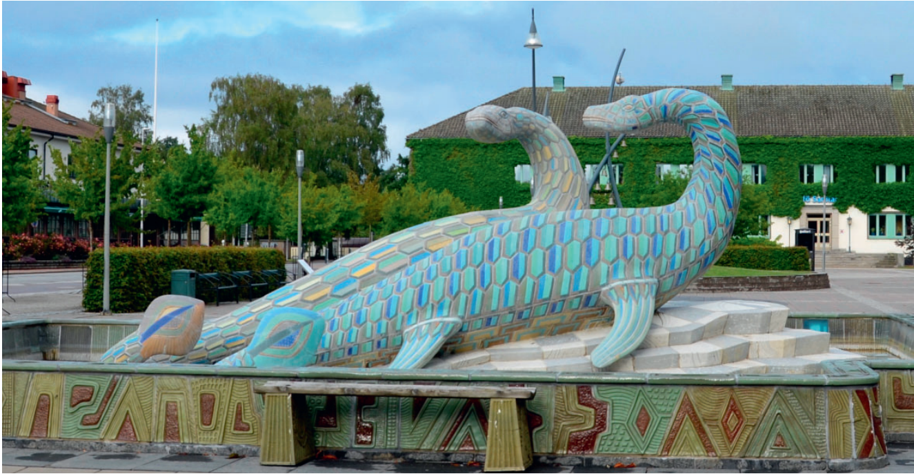
Figur 9.24. Scanisaurus från 1971 på torget i Bromölla. På håll ser allt bra ut men vid en närmare granskning träder en annan bild fram. Ett stort antal keramiska plattorna har spruckit och dessa yttre skador har sitt upphov i skador i den armerade betongstommen. Foto: Stefan Holmgren.
