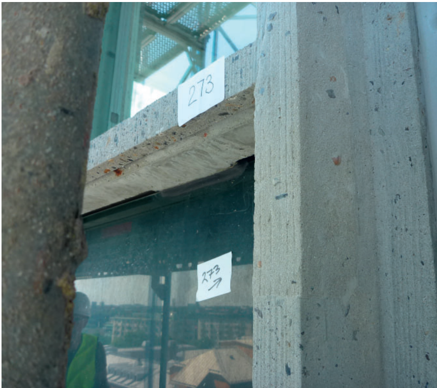
Figur 9.19. Detaljbilder av en armerad fönsteromfattning med en av fasadens omkring fyrahundra skador. Skadorna kategoriserades som strukturella, medelsvåra eller estetiska. Den här skadan föll inom kategorin medelsvår. Betongen hade karbonatiserat runt den rostangripna armeringen. Först vattenbilades skadan till frisk betong, varpå den slammades och järnet rostskyddsbehandlades. Slutligen putslagades skadan med bruk/betong. Foto: Stefan Holmgren.
