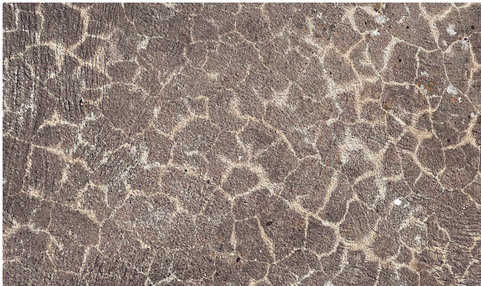
Figur 5.11. Torksprickor i ytan av en betongplatta. Mönstret har sannolikt uppkommit direkt vid gjutningen då materialet inte har haft tillräckligt mycket vatten för den kemiska reaktion som sker då cement hydratiserar. Foto: Sven Olof Ahlberg, 2022.
