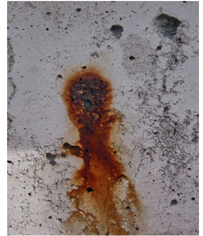
Figur 7.36. En brun järnhydroxid fläck på en betongyta som är orsakad av järnhaltiga ballastkorn. Foto: Katarina Malaga.
