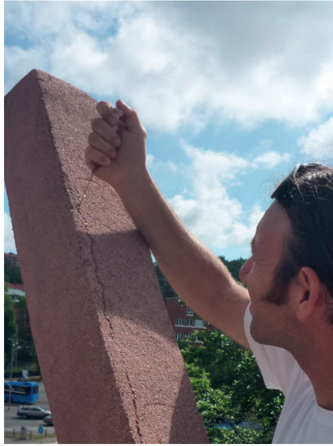
Figur 9.17. Betongytan hade även spruckit med många fina sprickor som injicerades med pigmenterat bruk. Foto: Stefan Holmgren.
