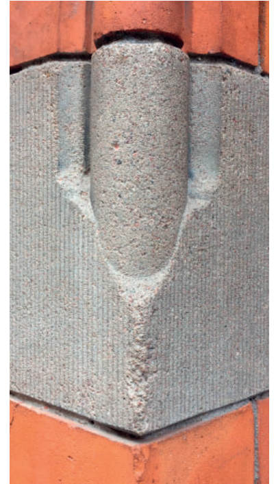
Figur 2.10. En delvis reffelhuggen passbit av stampbetong mellan vanligt tegel och profiltegel på fasaden vid Östermals Saluhall byggd 1888. Foto: Sven Olof Ahlberg, 2022.
