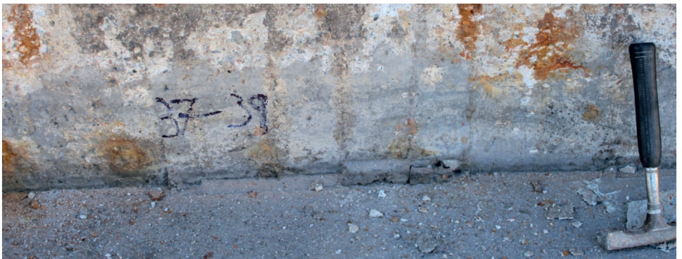
Figur 7.21. Bruna missfärgningar på en betongyta som indikera armeringskorrosion. Det regelbundna avståndet och de parallella stråken avslöjar att det är armeringskorrosion. Foto: Dimitrios Boubitsas.
