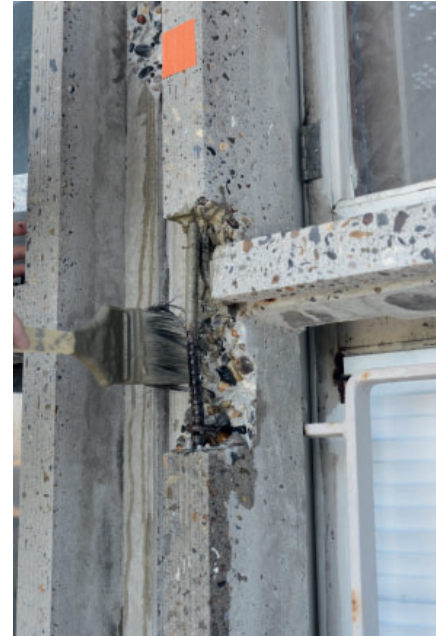
Skyddande beläggning på armeringen.
