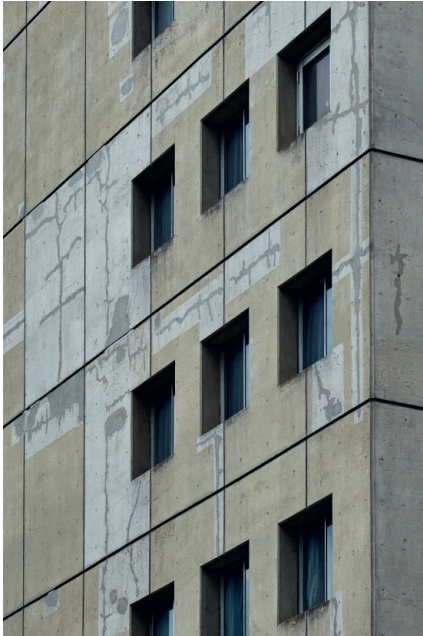
Figur 8.7. Reparerade sprickor i fasad-element på ett bostadshus i Tokyo. Orsaken till sprickorna är okänd. Foto: Urs Müller.
