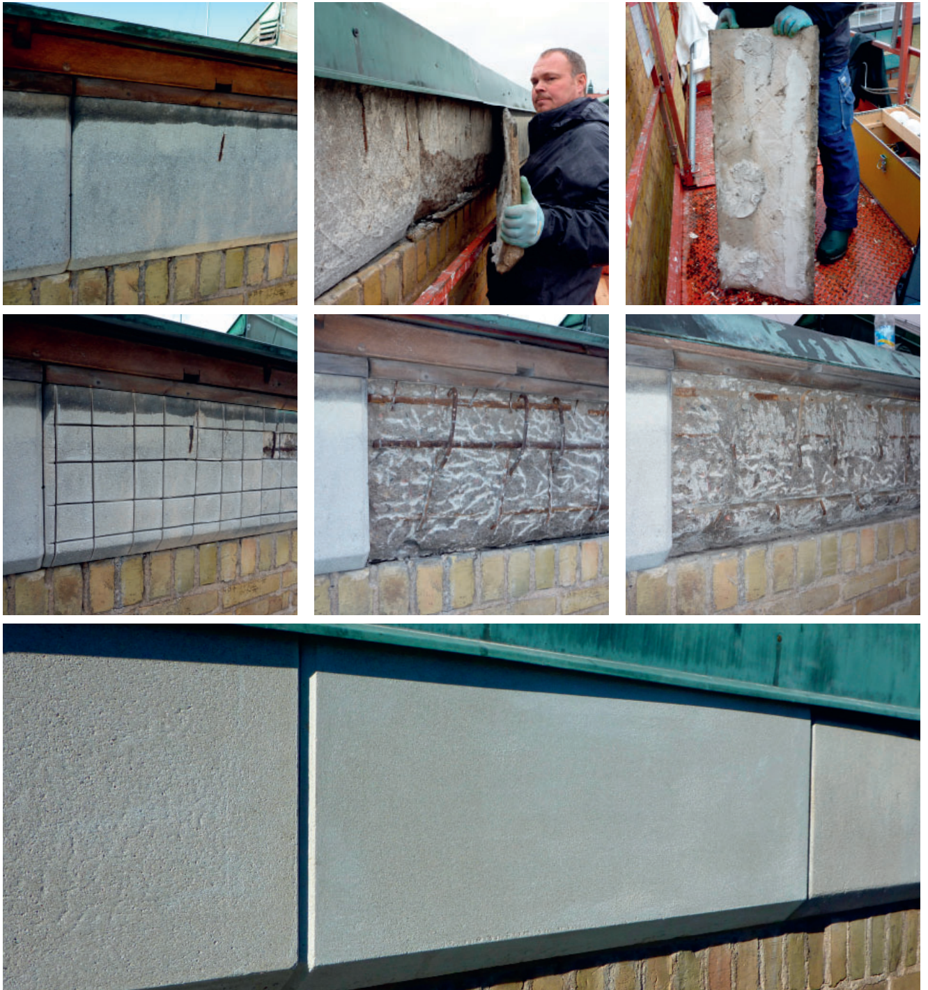
Figur 9.13. De segment som satt lösa demonterades. Några satt så löst att de kunde brytas loss medan andra sågades sönder. Därefter avlägsnades alternativt rostskyddsbehandlades all rostig armering
