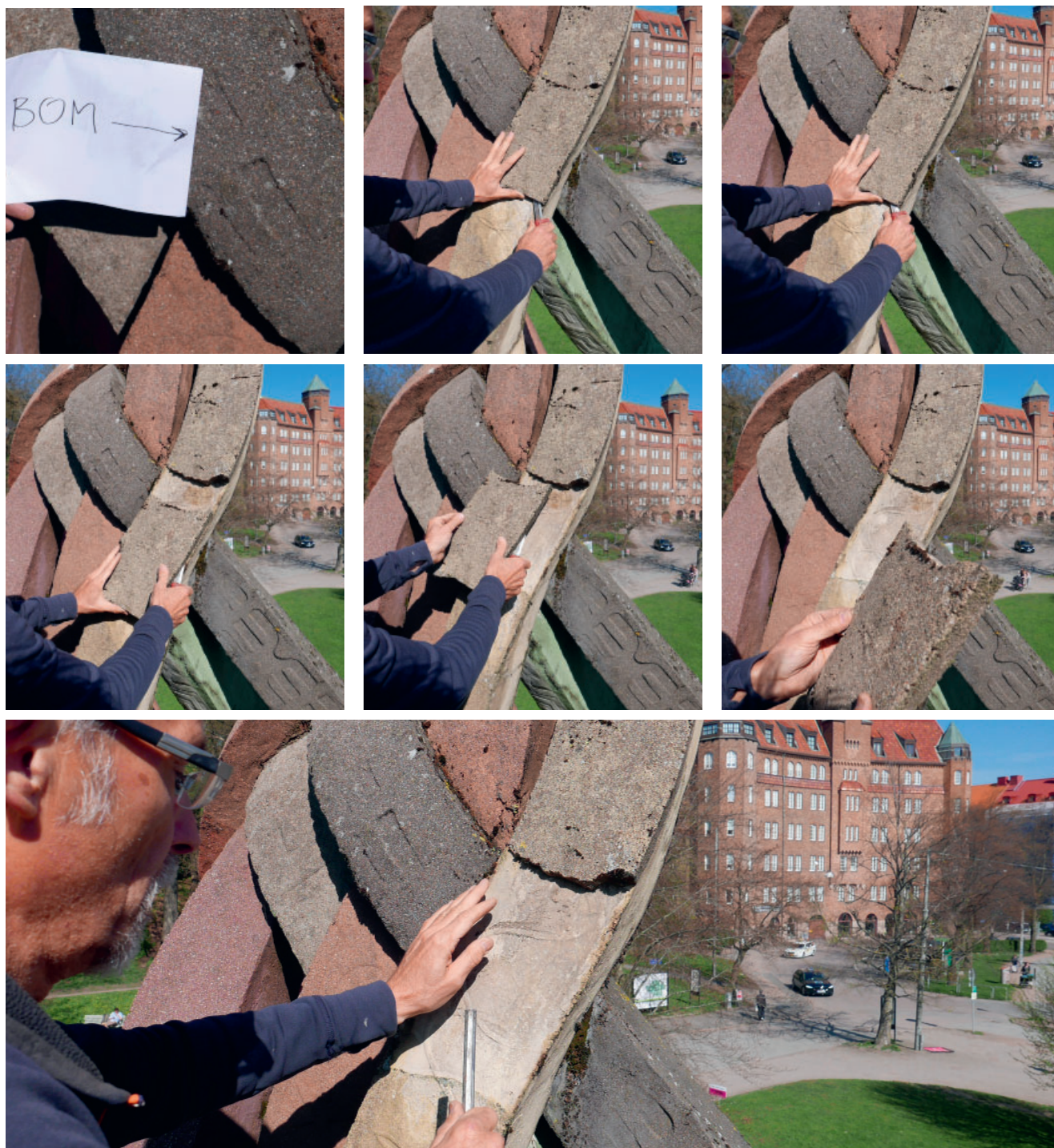
Figur 9.15. De flesta skadorna på skulpturen gemenskap fanns på den gjutna fläta som håller ihop skulpturens ben. Skadorna var sannolikt orsakade av någon brist vid gjutningstillfället. Under
