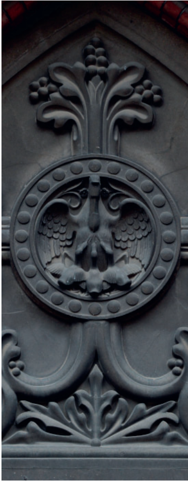
Figur 2.9. Oarmerad betong eller konststen som det även kallades är möjlig att göra extremt finskuren och detaljerad om bara formen är tillräckligt exakt. Detta rikligt ornamenterade parti infärgad svart stampbetong sitter över en av sidoingångarna till S:t Johannes kyrka i Stockholm, uppförd 1890. Betongen är gjuten av AB Skånska Cementgjuteriet som ett av deras första arbeten i Stockholm. Trots att det har passerat 130 år sedan kyrkan invigdes är materialet i förvånansvärt gott skick med helt intakt cementskiva – den fina yta som bildas närmast gjutformen. Foto: Sven Olof Ahlberg, 2020.
