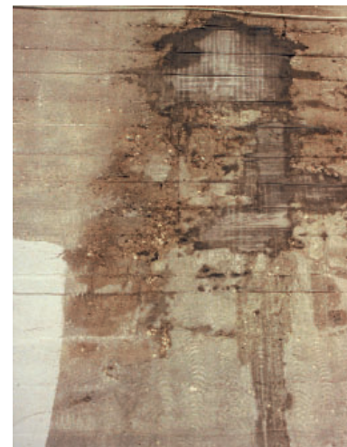
Figur 4.18. Armeringen i ridhusets tunnvalv hade rostat och sprängt bort det tunna betongskiktet. Betonglagningarna utfördes med stor omsorg, nya gjutformar formades efter den befintliga strukturen och betongen injicerades in bakom formen. Till vänster i bilden ansas provmålning för att få en enhetlig yta. Foto: Lone-Pia Bach 1998.
