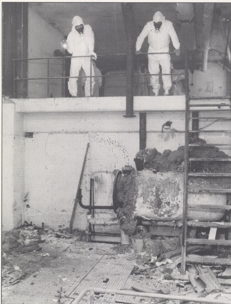
Det finns mycket asbest inbyggt i väggar och tak, värmepannor, rörisoleringar mm. De yrkesgrupper som kommer i kontakt med asbest är i första hand byggnadsarbetare, byggnadsstädare, personal som arbetar med rivning och sanering och på rörfirmor samt bilmekaniker.
