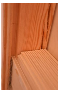
Fig. 66, Isotimber 110 mm med 12 mm plywood P30 i spår på in- och utsidan. Spåret på insidan är 16 mm, vilket medger drevning.
