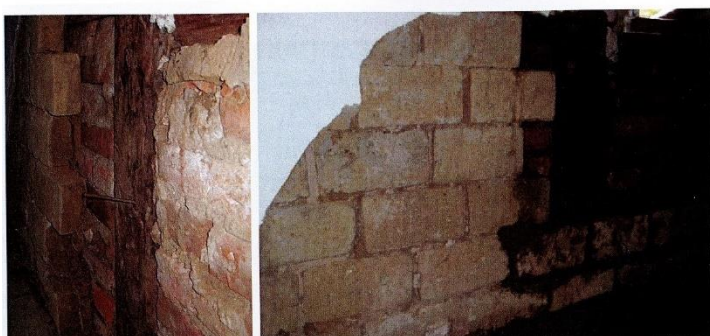
Bilder tagna på Bondrumsgårdens stugas innervägg mot gården. Man ser på bilderna att de yttre facken består av bränt tegel liggande på flasken medan innerväggens lerstenar är murade på högkant. På bilden till vänster syns en spik i stolpen vars uppgift är att hålla ihop de bägge väggarna. Det vita på den högra bildens övre vänstra hörn är vittad puts. Se även foto framsida.
