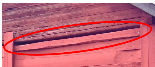
Fig. 1, Krympning av skiften som ger en springa vid mötet med gavelröstet. Skiftesverkslada i Solnehult med nya skift.
