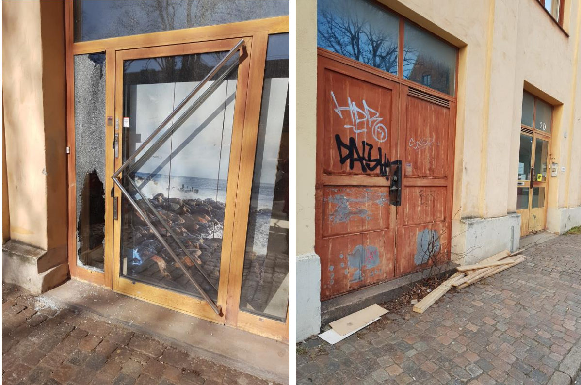
Skadegörelse vid Kronhusgatan
