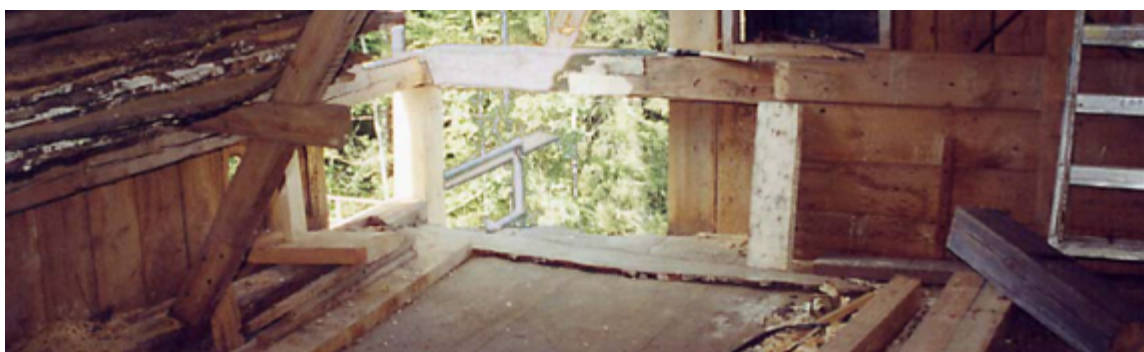
Figur 22. Vinden är klädd med stående locklistpanel. Översta skiftet ligger precis under golvet. Takläckage har med tiden skadat stolpverket så pass att man var tvungen att renovera stolpverket. Bilden är tagen vid renoveringen. Carlquist (2010, s. 21).
