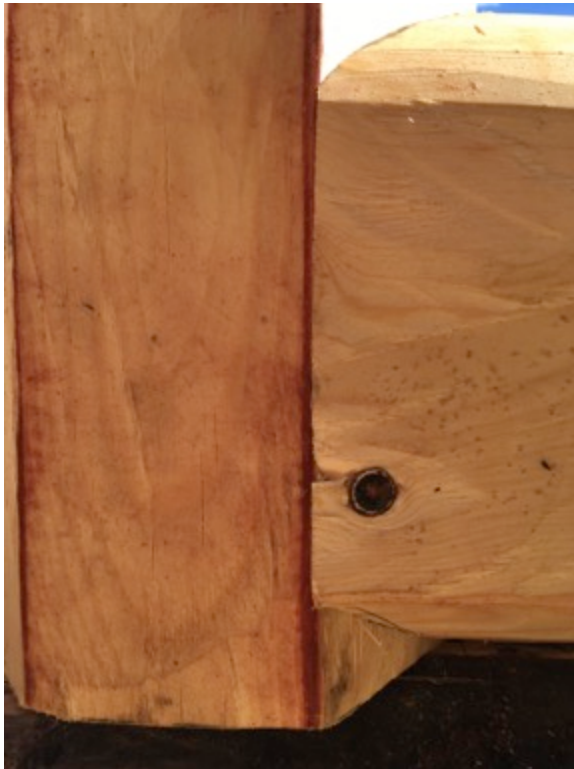
Figur 73. Stolpen till vänster och skiftet till höger. Det röda strecket är kvar från snörslagningen då stolpen höggs.
