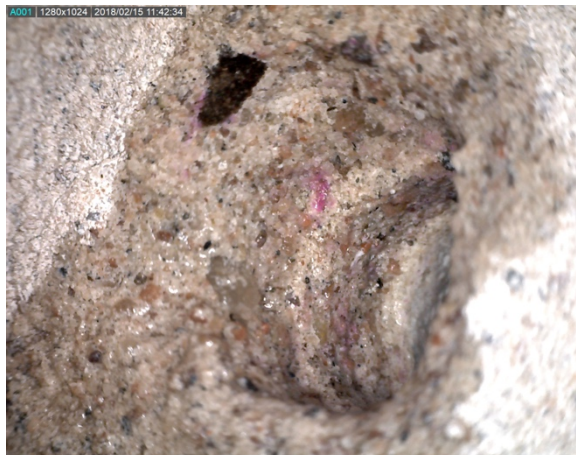
Figur 11 (Foto: Mikel Thorstensen). Bilden visar den skurade putsen (puts B) vid det sista provtillfället. Fotot är taget några sekunder efter applicering av fenolftalein. Undersökningen ansågs vara färdig då inget tydligt färgomslag hade skett.
