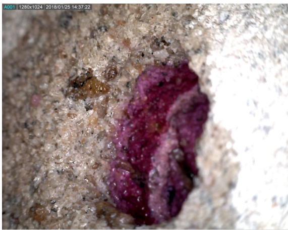
Figur 10 (Foto: Mikel Thorstensen). Bilden visar den skurade putsen (puts B) vid det första provtillfället. Fotot är taget några sekunder efter applicering av fenolftalein. Det lila området markerar okarbonatiserad puts.
