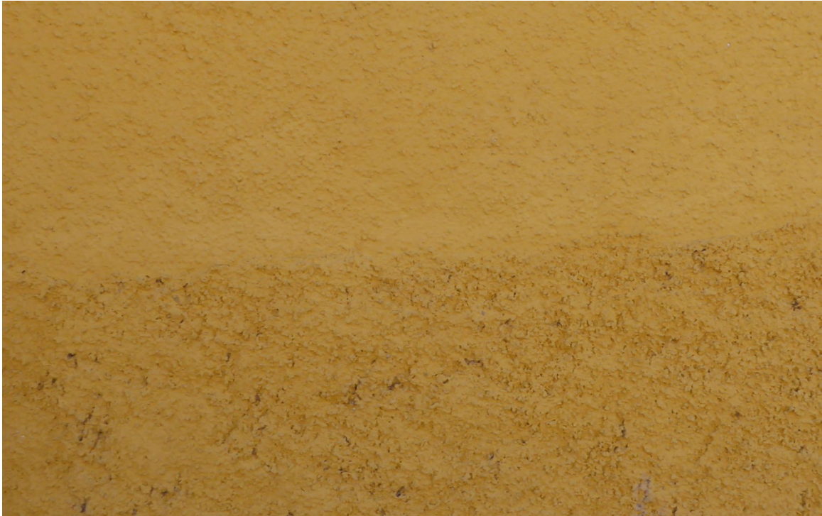
Figur 1. Gamla staden i Mariestad. En spritputsad fasad som utsatts för lagning som inte stämmer överens med originalputsens. Den undre delen av bilden utgör lagningen.
