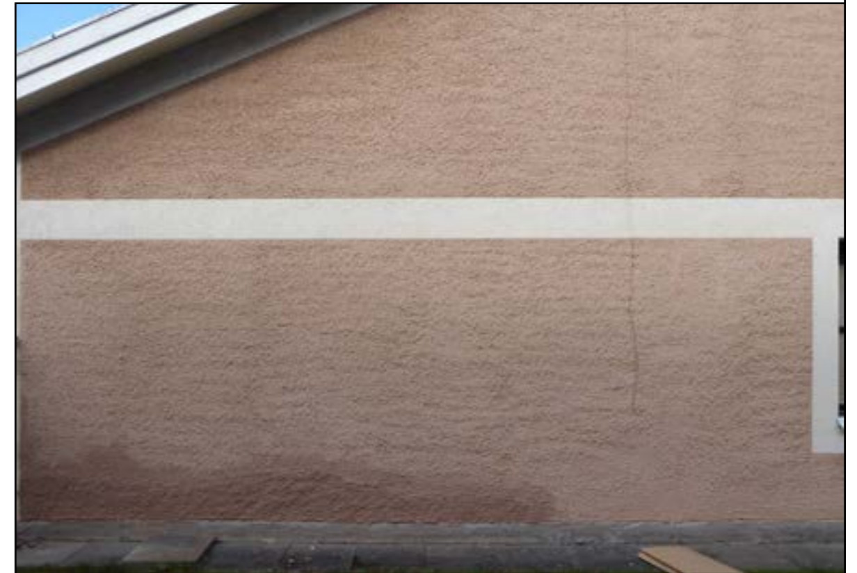
Fig. 1. Helhetsbild. Det mörka partiet nere till vänster är en lagning och ingår inte i undersökningen.
