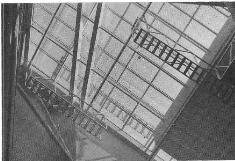
Figur 7.2 Installationer för rengöring av glastak
