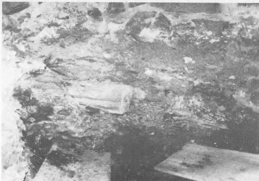
Bild 4: Byggnadens gamla grundläggning var ställvis utförd på rustbädd som nu nästan helt förstörts av röta. Bilden visar en ensam kvarvarande stock i en annars helt förmultnad rustbädd i det östligaste rummet.
