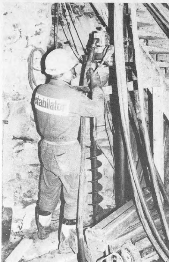
Bild 12: Förborrning genom fyllning med augerborr driven av en lätt tryckluftsmotor som monterats på en gejder med fotplatta.
