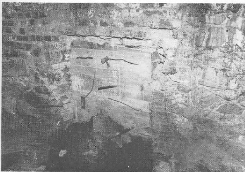
Bild 5: Den angränsande fastigheten var tidigare grundförstärkt med tryckpålar av betong. Bilden visar igengjutning av den gemensamma grundmuren.
