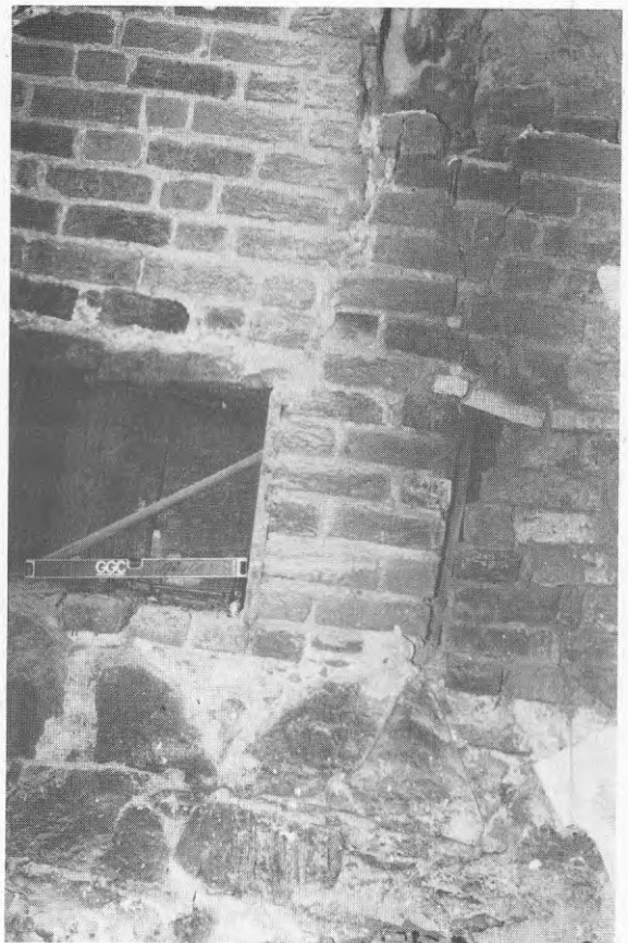
Bild 3: Vid den svåraste rörelsezonen var byggnaden allvarligt skadad med lutande väggar och stora sprickor i grundmurar.
