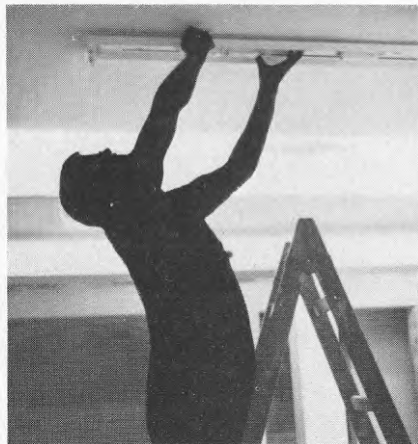
Uppsättning av armatur
