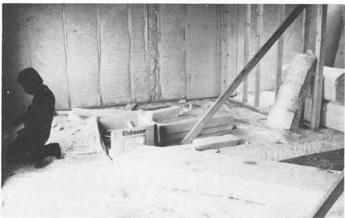
BILD 141 Isolering på plats innan installationen medförde att montören tvingades i kontakt med mineralullen.
