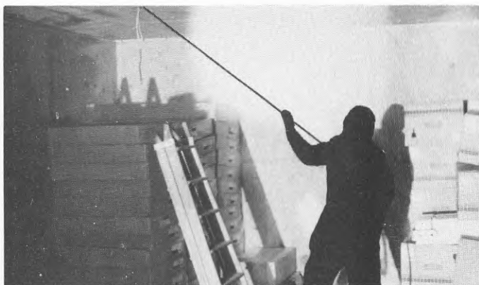
BILD 46 Tråddragningen försvåras av att utrymmet nyttjas som upplag.
