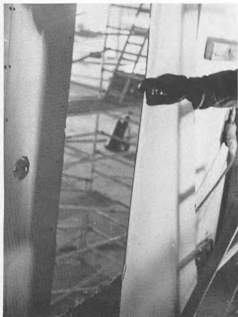
BILD 78 En montör utförde arbeten i taket från stegen som skymtar på bilden. Dörröppningen ut mot industrihallen var "igenbommad" med en plywoodskiva. Fri fallhöjd utanför dörren ca 5 m.
