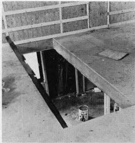
BILD 163 Skyddsräcke saknades vid trappöppningen. Risk för nedstörtning!
