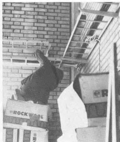
BILD 89 P.g.a. issoleringsupplaget blev arbetsställningar ofta onödigt riskabla och ansträngande.
