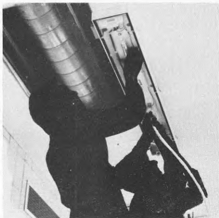
Koppling av armatur
