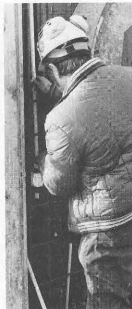
BILD 40 Rör ansluts till dosor.
