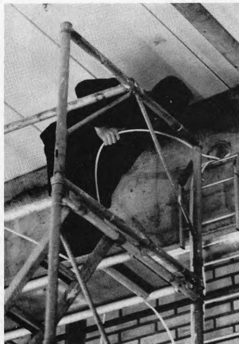
BILD 93 Ställningen saknar ledare in mot väggen - fallrisk.
