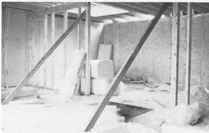
BILD 140 Materielupplag och skräp på arbetsplatsen försvårade installationsarbetet.
