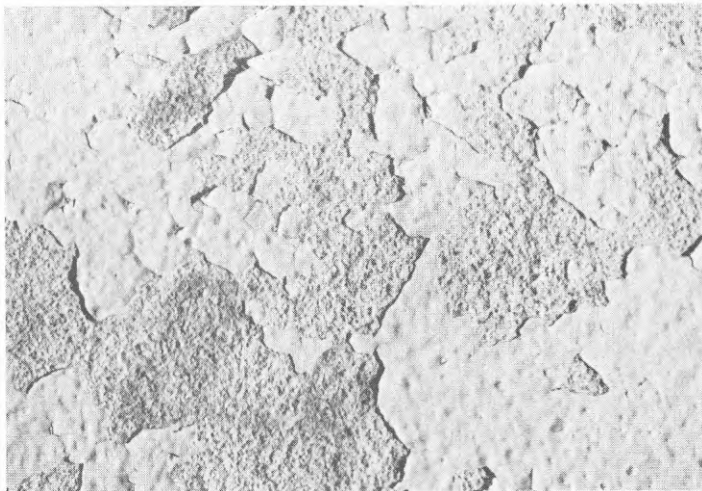
C 1a Flagning. Delar av färg- eller lackskiktet har lossnat från grunden, t ex puts eller träunderlag.
