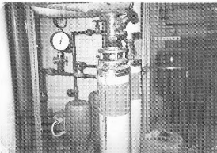
Figur 4.2. Solfångarkretsens pump- och tryckhållningsutrustning.
