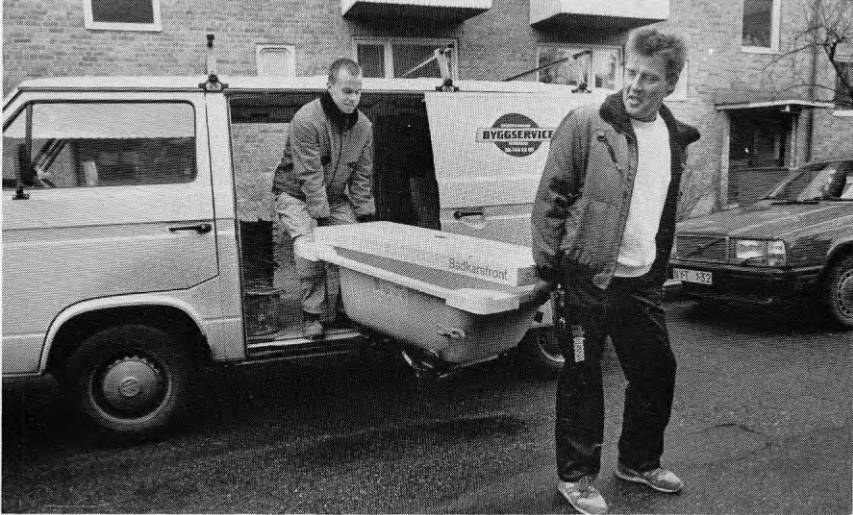
Figur B:5 Den anlitade rörmontören utför alla återmonteringar eller nyinstallationer av VVS-material. Han hjälper även till med tyngre lyft när han är på reparationsplatsen.
