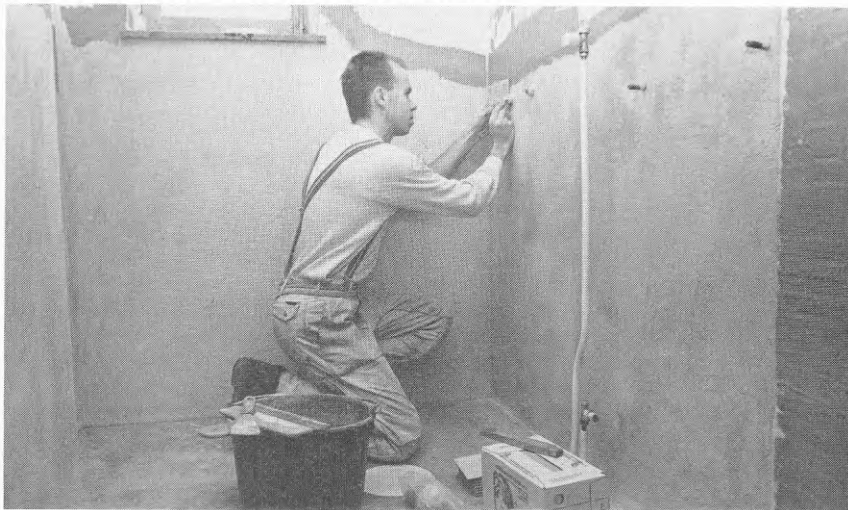
Figur B:3 Arbetaren utför som regel allt rivningsarbete inkl.VVS-utrustning, fuktisolerar, murar, gjuter och sätter kakel mm.
