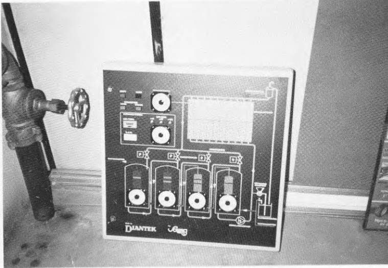
Figur 4.3. Foto av styrcentral.
