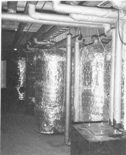
Figur 6.8. Foto av ackumulatortankar.
