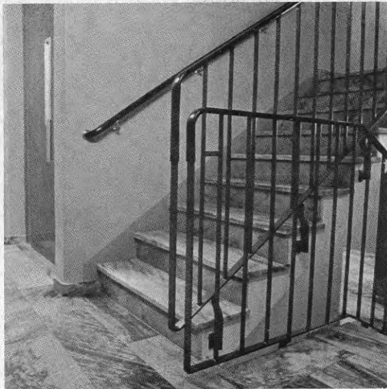
Bild 20.9. Trappan mellan arbetsförmedlingens avdelningar var olämpligt utformad. Handledaren fortsatte inte förbi första och sista steget. Detta och trappnosarna kan orsaka olyckor.
