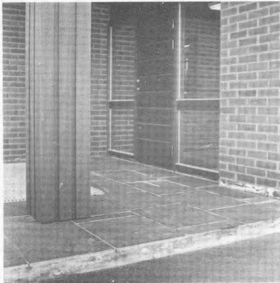
Bild 15.1. Nivåskillnaden vid entréen gjorde att en rullstolsbunden person inte skulle kunna komma in i byggnaden utan hjälp. Entrédörren var tung och hade ett vanligt dörrtrycke, vilket gjorde den svår att öppna.
