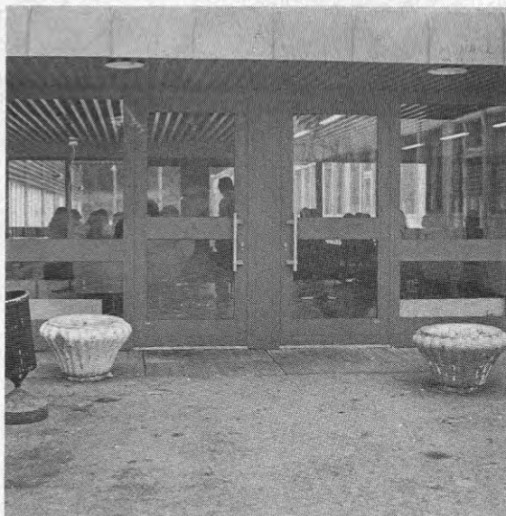
Bild 16.1. En rullstolsbunden person skulle ha svårt att öppna den tunga entrédörren och en kant hindrade framkomligheten. Fasad och dörrparti var enhetligt färgsatt. Dörrarna var därför svåra att urskilja för synskadade.
