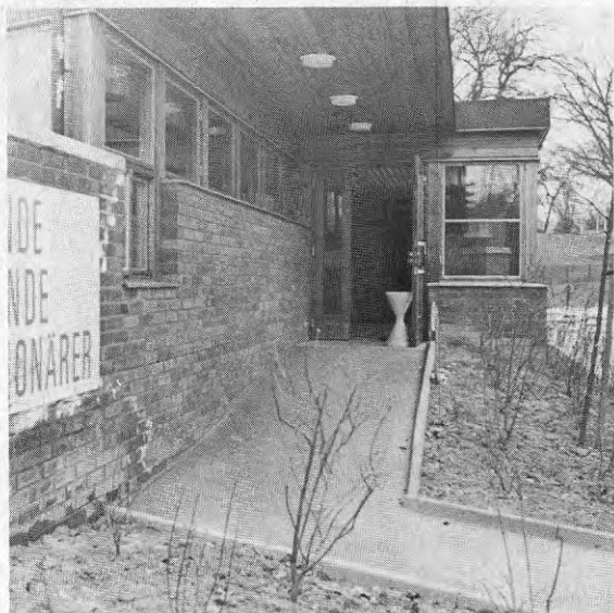
Bild 18.5. Idrottsplatsens omklädningsbyggnad var försedd med en kort ramp upp till dörren, vilket var bra för rullstolsbundna. Tyvärr fanns en liten nivåskillnad vid själva ingången.
