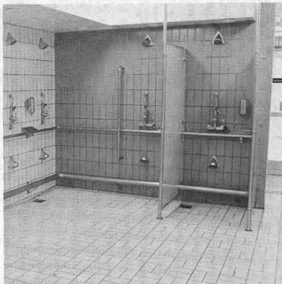
Bild 14.5. Stora fria golvytor i tvättrummet gav bra svängrum för rörelsehindrade. Handedare fanns och en rörelsehindrad som använde rullvagn kunde använda fotstödet nertill som förflyttningshjälp.
