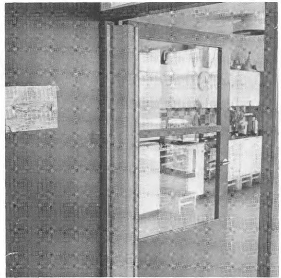
Bild 19.4. I förskolans lokaler fanns dörrar med gångjärn som man skulle kunna klämma fingrarna i. Plastmatta var uppsatt som skydd, men endast på dörrens ena sida.
