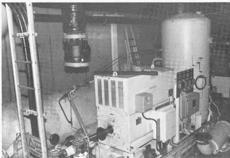
Figur b4.3 Ett av värmepumpaggregaten med elmotor och oljeavskiljare men med kompressorn bortmonterad.
