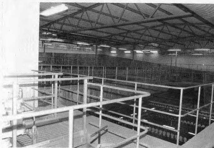
Figur 2.5. Foto över Blynäs reningsverk.
