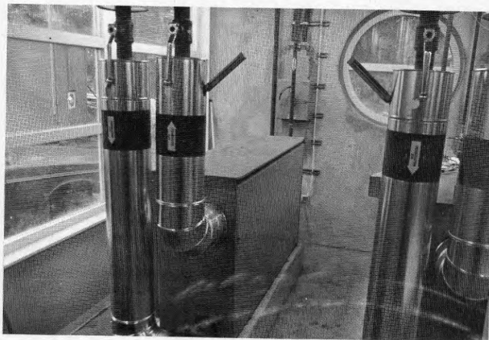
Figur 3.1. Foto av elpannor.
