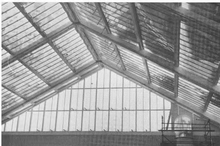
Fig 13:5 Interiör av glastak och vägg med elektriska ventilations/rököppnare
