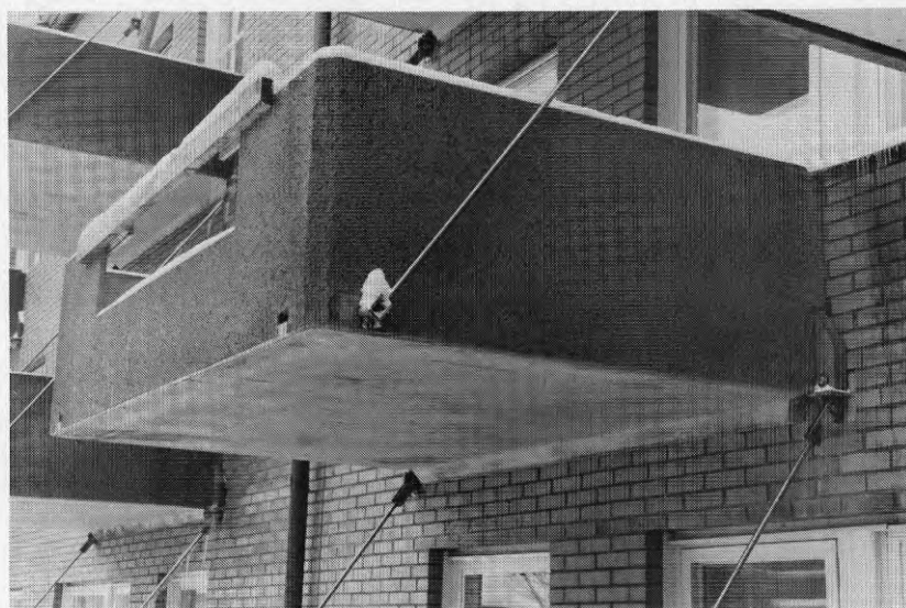
Fig 11:9 Balkonger, observera punktfästningen i vägg som är utformad för att undvika alltför stora köldbryggor
