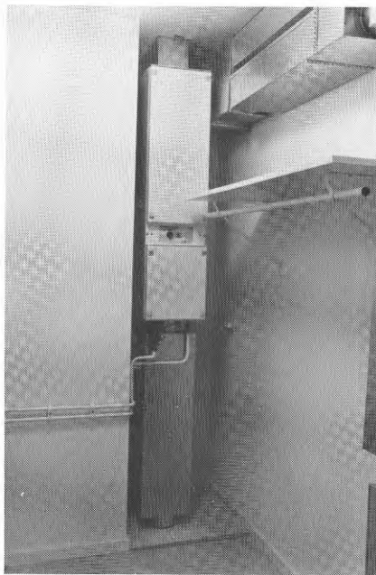
Bild 12:1 Varmluftaggregat, placerat i lägenheterens kläd-kammare
