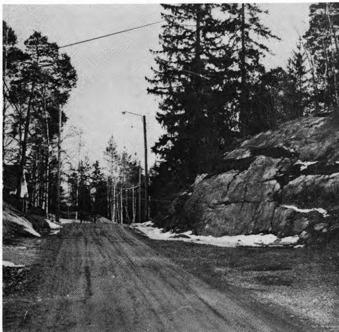
FIG 5 Bergslänt inom befintligt vägreservat. Breddning ger ful och kostsam bergsskäring.
