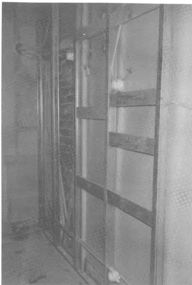
Fig. 16. I Ugnen 10 satte man en helt ny gipsvägg på regler i köken. Den döljer gamla rör och ojämnheter. De nya köksskåpen skruvas fast i reglarna.
