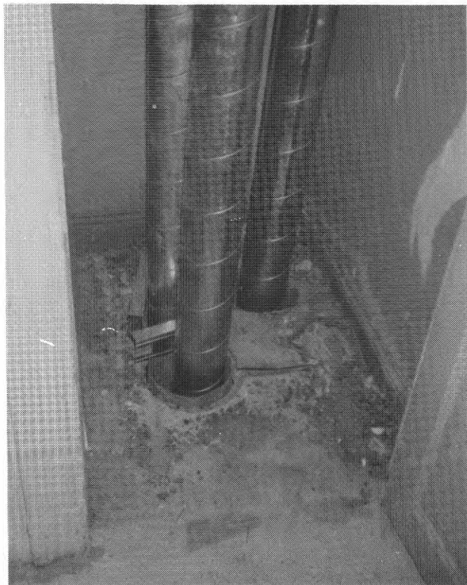
Fig. 13. På ritningen ser det ut att vara raka spåret. I verkligheten är hålen borrade olika i varje våning beroende på var de bärande bjälkarna ligger. Här ventilationstrummor från butiken som dras genom garderober upp till taket.
