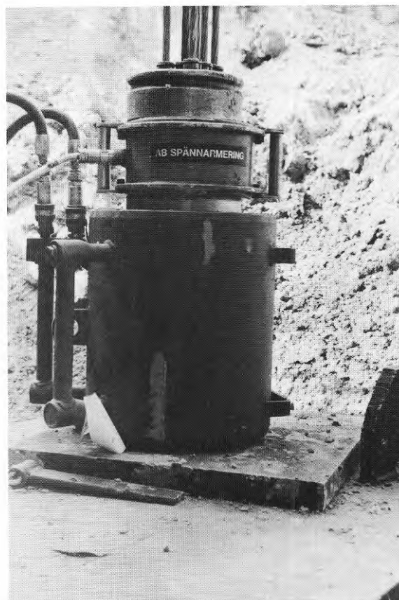
Domkraft och kraftgivare
