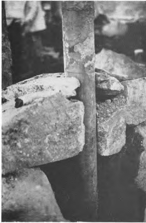
b) Detalj av foderröret i stenblocken. Som synes har foderröret träffat en kant av muren och gjort urtag bland stenblocken. Förskjutningar av murens övre delar kan märkas.
