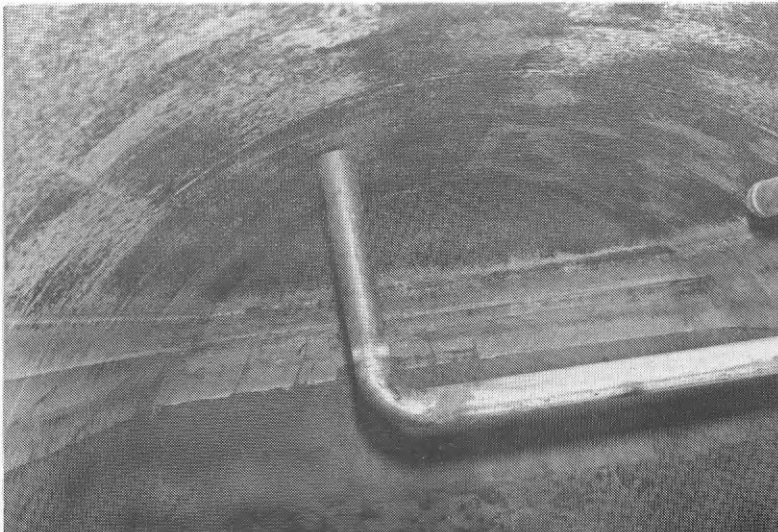
Bild 12 Tilloppsledning till värme- och tappvarmvattensystemen.
