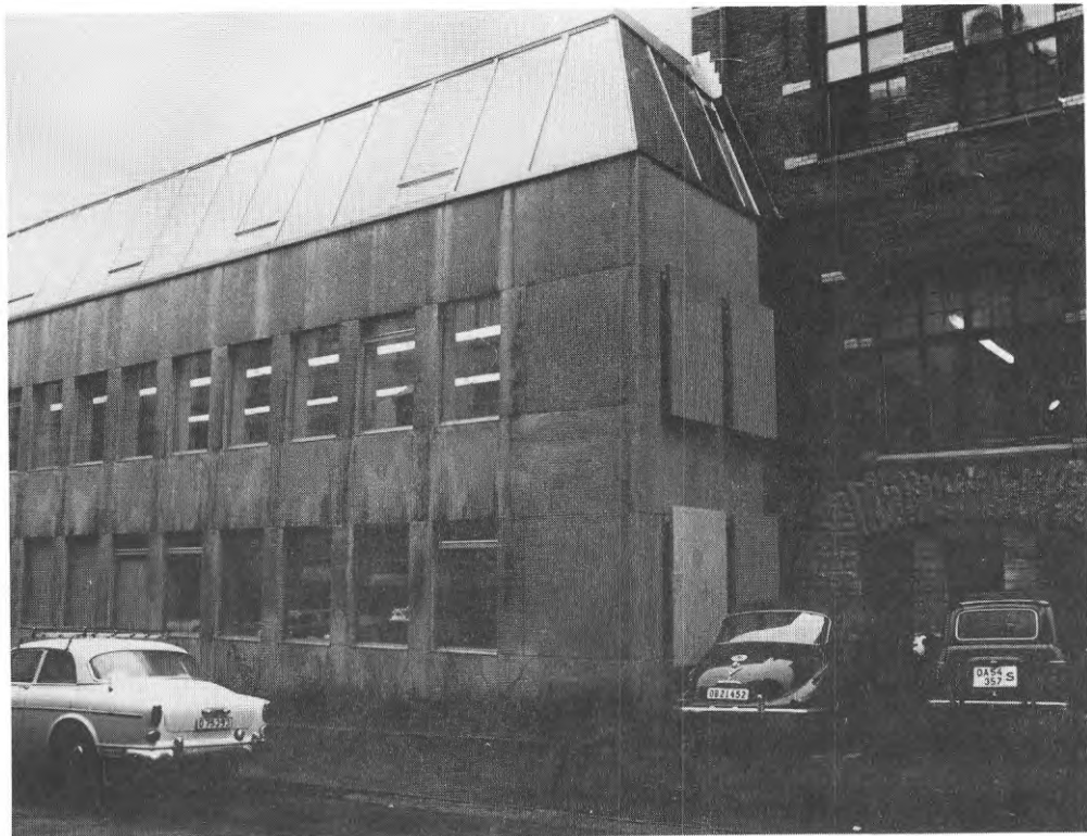
Bild 14. Detta är ett exempel på hur ett skrovligt material inte bör användas i en starkt nedsmutsande miljö. Glaspartiet ovanför fasaden och fönsteröppningarna i denna medför, att vattenströmmarna över fasaden blir rikliga och ojämnt fördelade.
