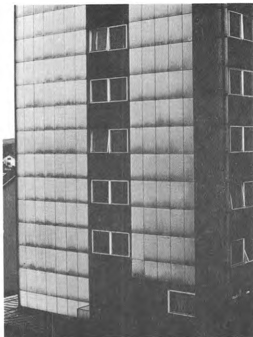
Bild 10. Föroreningarna sitter kvar längs nederkanten av fasadelementen. Detta kan undvikas, om elementen monteras så att ett kontinuerligt vattenflöde över fogen möjliggöres.
