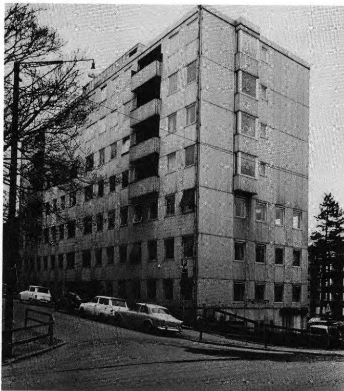
Bild 19. Byggnaden ligger relativt fritt och fasaden utsätts för stora mängder regnvatten. De korrugerade al-plåtarna dränerar fasaden väl, vilket leder till jämn rentvättning. Under burspråket tvättas ej fasaden lika effektivt som i övrigt då denna del ligger i regnskugga.
