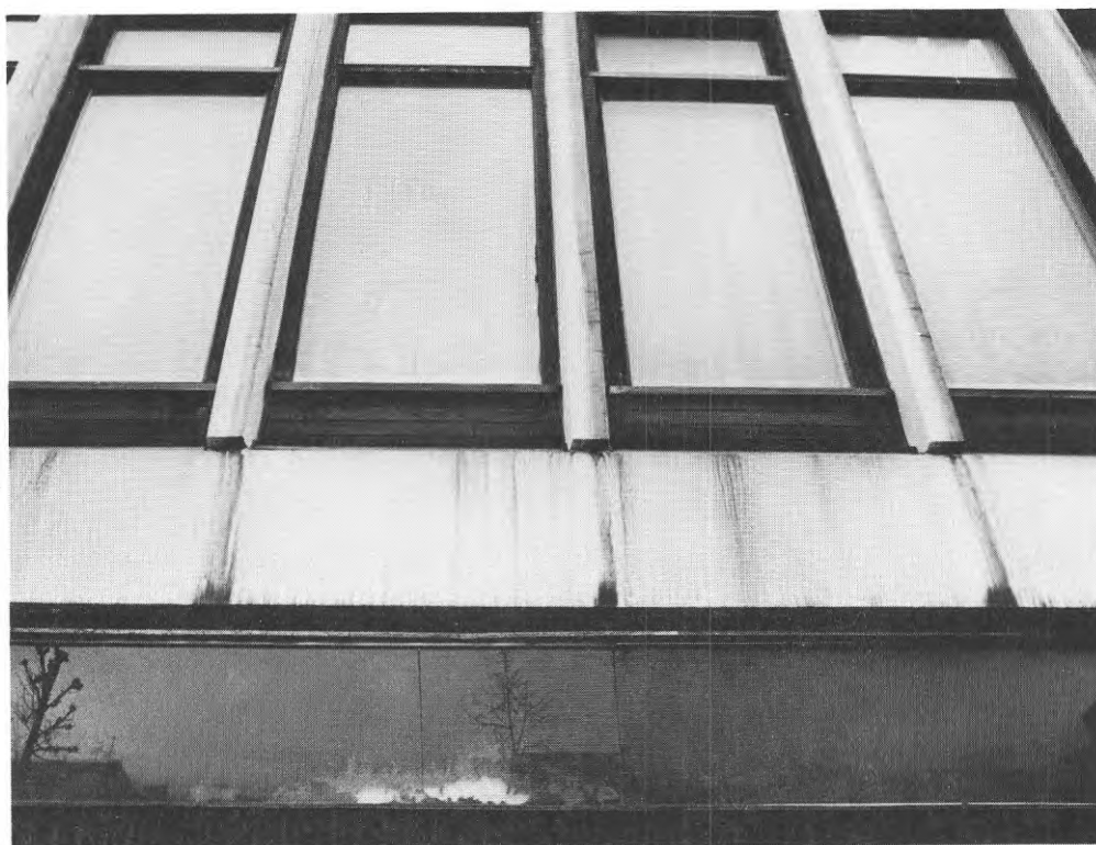
Bild 29. Under pilastrarna tvättas ej fasadbalken av det rinnande vattnet. Gaturummet har en förhärskande slagregnsriktning och pilastrarna tvättas där i huvudsak på en sida.
