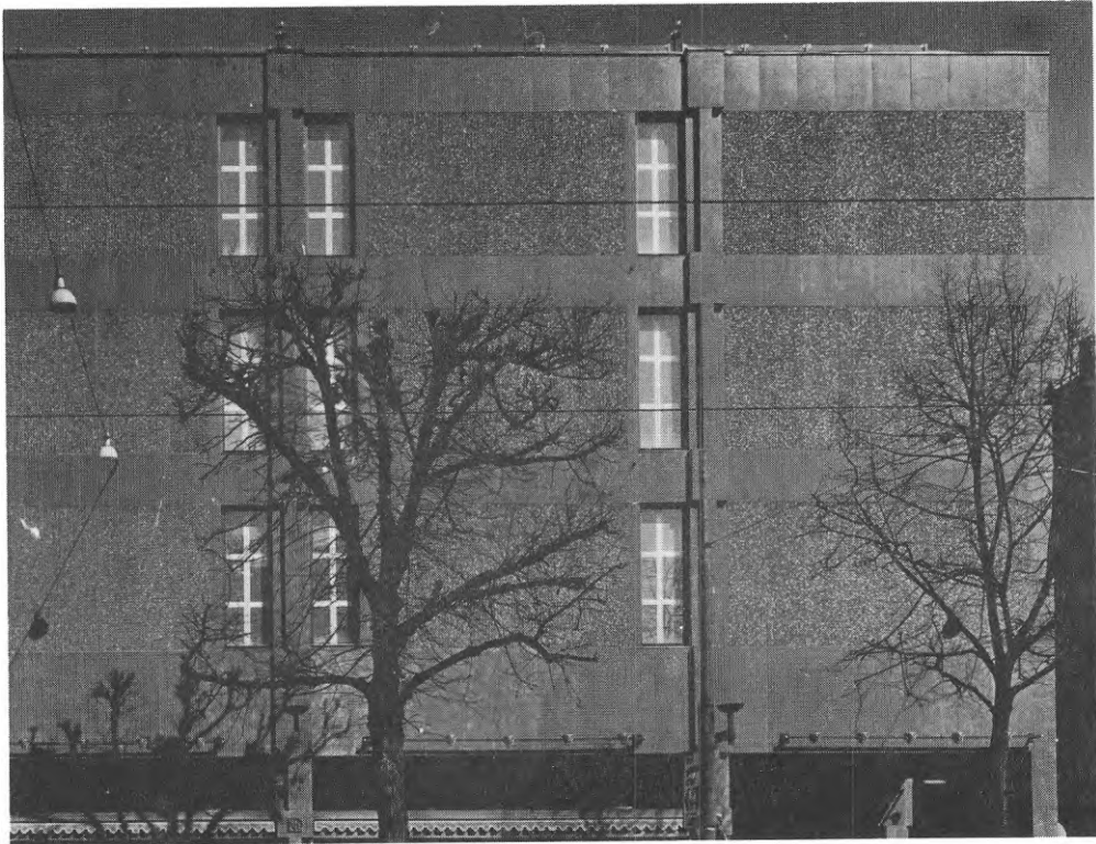
Bild 13. Den mörka färgen på ballastelementen och konstbetongskivorna är fördelaktig ur nedsmutsningssynpunkt men materialkombinationen är mindre lämplig. Ballastskivorna samlar på sig stora mängder föroreningar och regnvatten. När regnväddet upphör, rinner detta ner över konstbetongskivorna. Dessa smutsas då av de föroreningar, som följer med vattnet.
