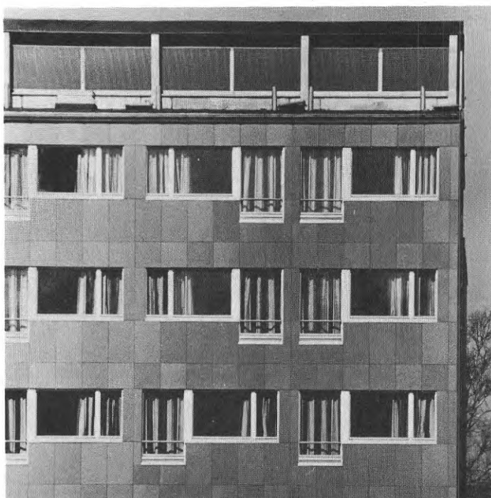
Bild 15. Asbestcementskivorna har tre olika, närliggande kulörer. Detta torde förta intrycket av nedsmutsningen.
