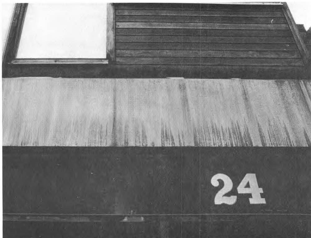
Bild 30. Regnvattnet fäller ut kopparsalter ur träimpregneringsmedlet och dessa missfärgar fasadbalken.
