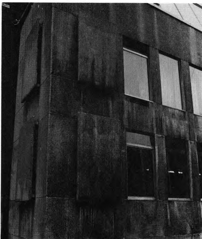
Bild 27. Skivor monterade utanför fasadlivet smutsas ofta mycket kraftigt. De tvättas även ojämnt av regnet och får därför kraftigt markerade nedsmutsningsbilder.
