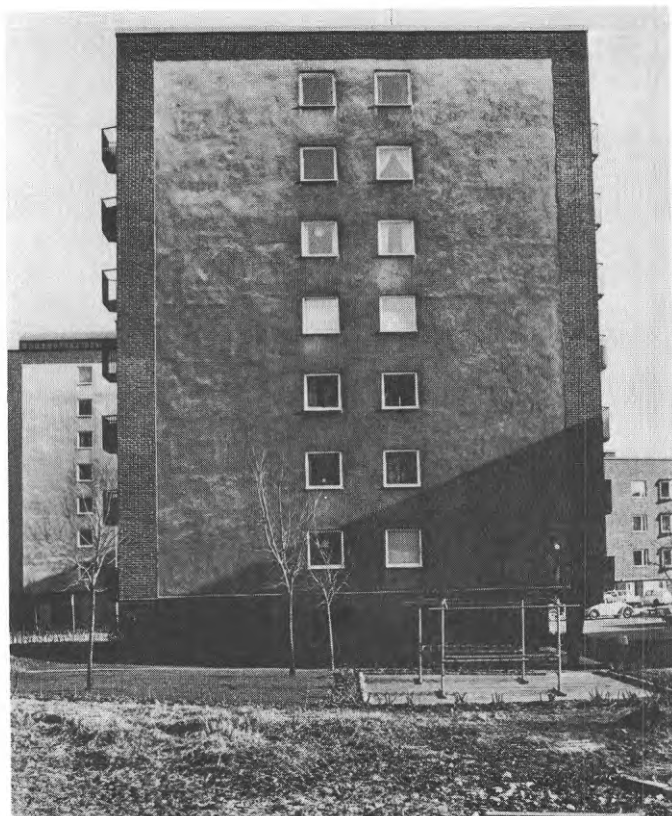
Bild 20. Läfasaderna blir ofta starkt nedsmutsade, då någon effektiv regntvättning sällan förekommer. Den ojämna nedsmutsningen av denna fasad beror på putsytans ojämnhet.
