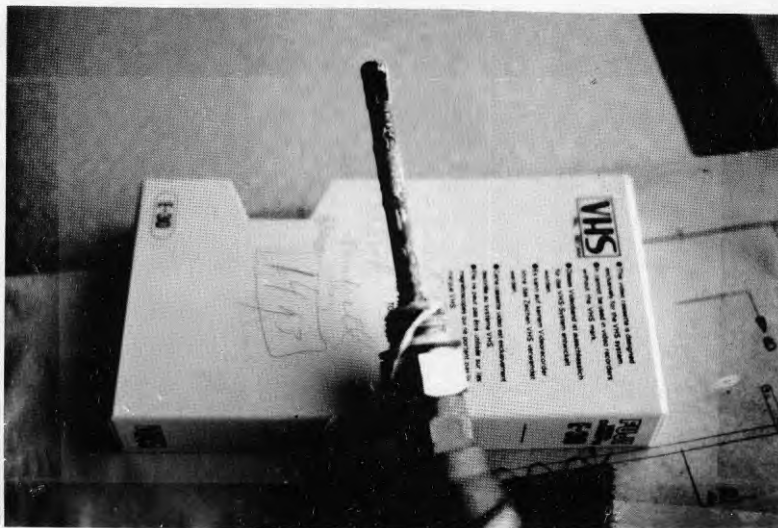
Figur 4.7 visar temperaturgivare. Typ PT 100. På denna ses korrosionsangrepp och beläggningar orsakade av det syresatta vattnet.
