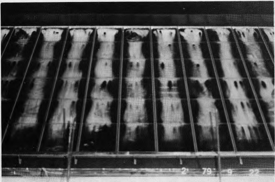
Figur 7 Kondens på solfångare innanför glas. Största kondensmängd i de övre delarna. Fotot är taget kl 02.00.
