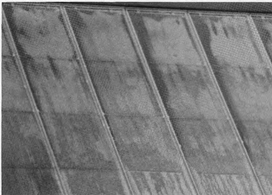
Figur 4.1 Kondens kan skönjas som ljusare partier under glaset i några solfångare.
