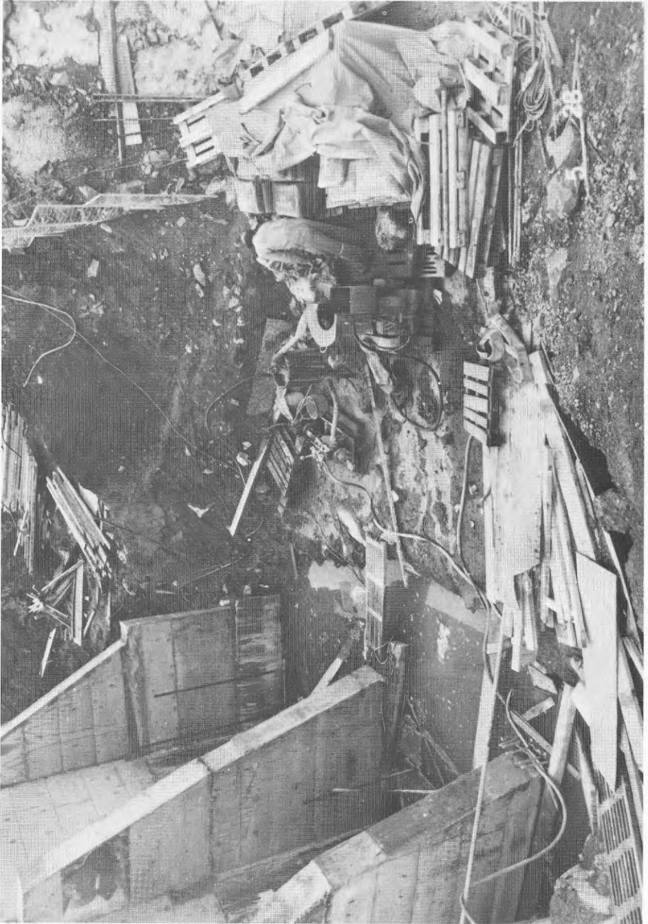
Figur 3.5 visar lagerväggens stödfundament. Obs! grundvatten. Fotot liggande.
