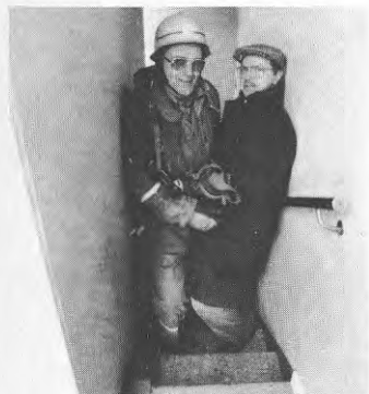
Nog är det trångt allt. Här har 90 cm blivit 70 cm. Risk för att utrymningsvägen proppas igen vid brandlarm.
