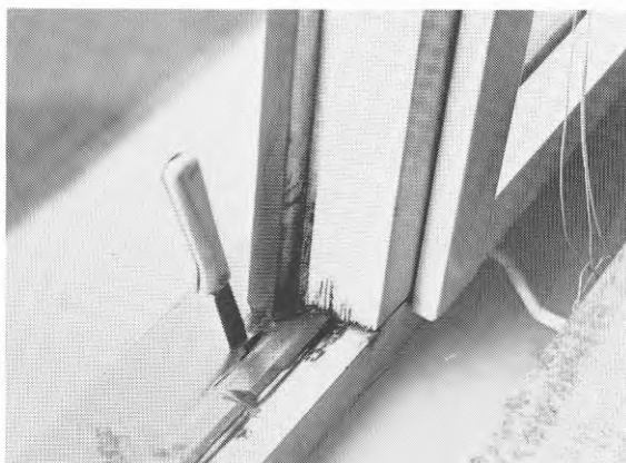
Figur 5.1.3 c. Rötskada i karm- bottenstycket in- till mittposten.
