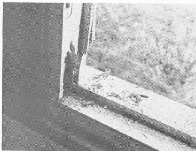
Figur 5.1.7 b. Rötskada i karmsidstyckets nedre del.
