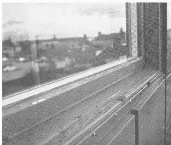
Figur 5.1.11 b. Rötskada i karmbottenstyckets framkant.
