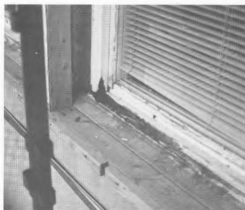
Figur 5.1.6 c. Befintligt fönster med rötskada i karmbottenstycke och sidstycke.
