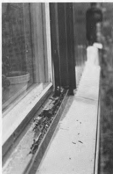
Figur 5.1.12 b. Rötskada i karmens bottenstycke och sidstycke.
