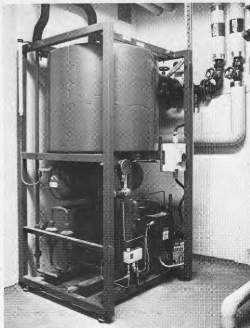
Figur 2.7 Kondensorn och kompressorn till värmepumpen i hus A
