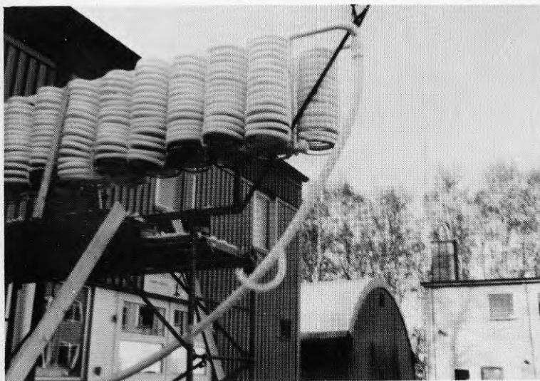
Fig B3.10 Avfrostning av cylinderstaket.
