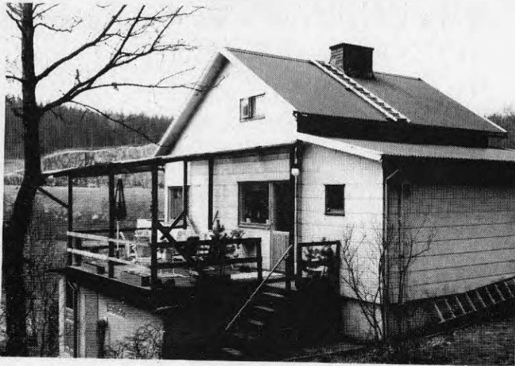
Figur 41. Sommarbostad utnyttjad som åretruntbostad. Fasadbeklädnad: Eternitplattor. Små befintliga takutsprång gör att taken måste byggas ut för att väggarna skall kunna tilläggsisoleras på utsidan.
