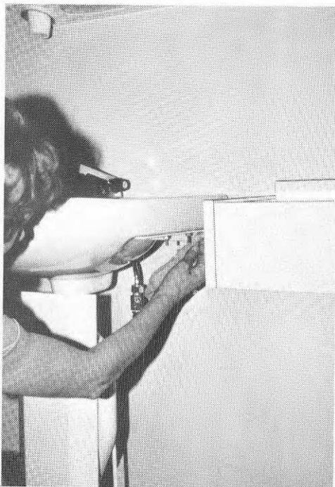
Fig 3:186 Avtorkning av konsolmonterat tvättställ. Observera de långa skruvarna
