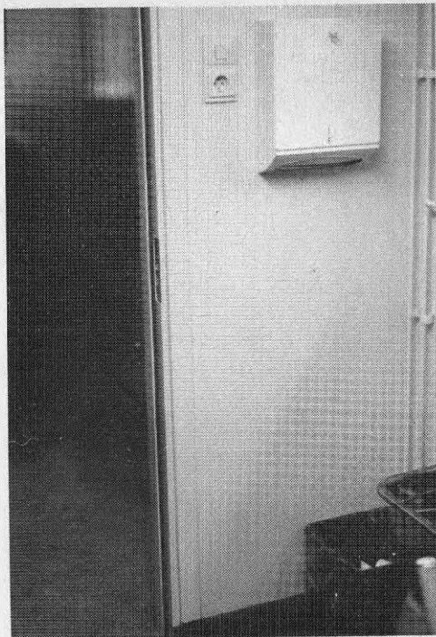
Fig 3:201 El-uttag i städtrum i kombination med ström- brytare för takarmatur Bra placering från städsynpunkt
