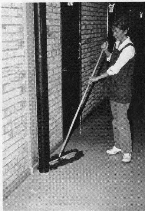
Fig 3:167 Rörledningar från invändig takav- vattning Hindrar effektiv mopning. Dålig utformning från städsynpunkt
