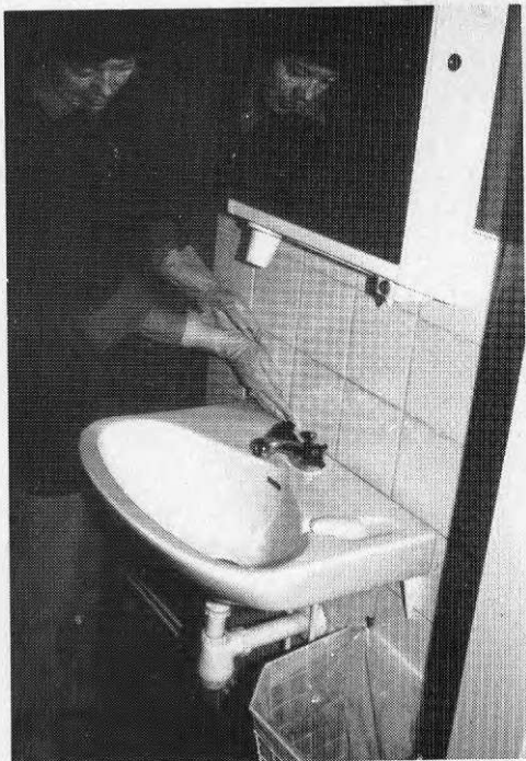
Fig 3:187 Konsolmonterat tvättställ Städaren kommer ej mellan vägg och tvättställ med hand och duk Dålig utformning från städsynpunkt
