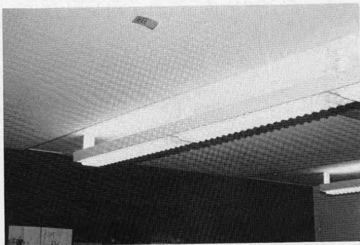
Fig 3:207 Exempel på ljusarmatur monterad med avstånd från tak
