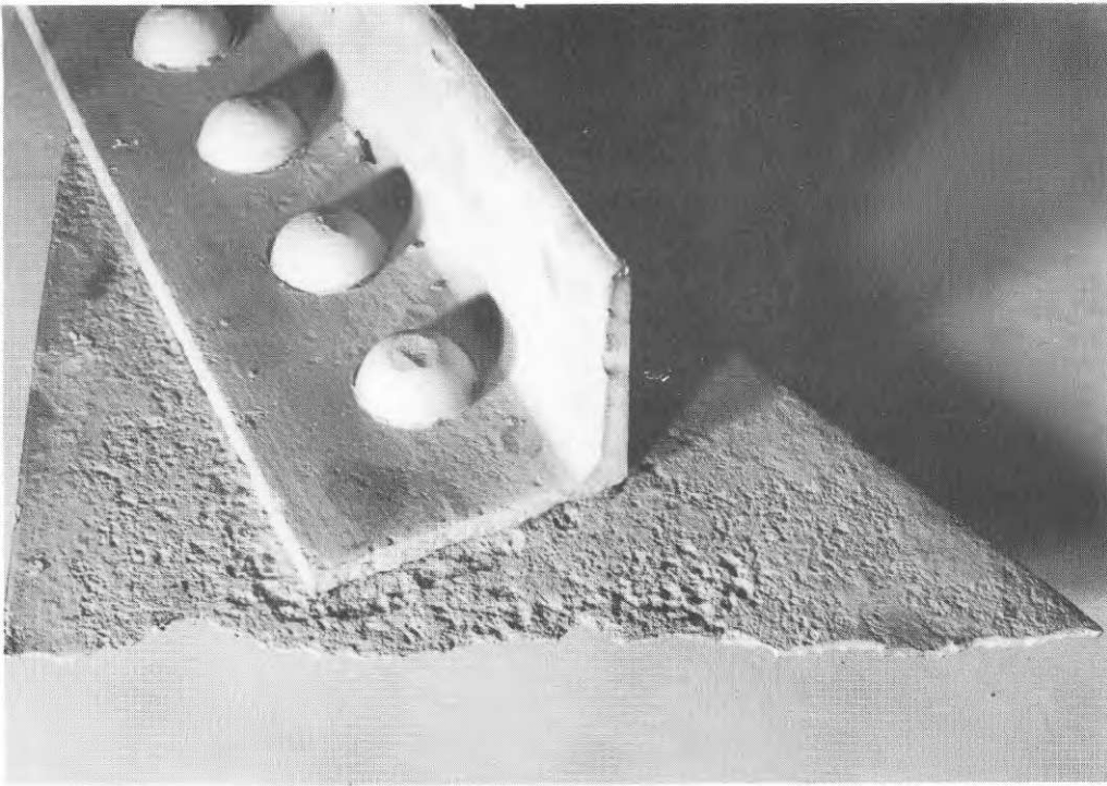
Fig. 15 Helt avrostad knutplåt, godstjocklek 6 mm, för infästning av vindförband i en gammal stålbro nära Stockholm. Avrostningen är en följd av atmosfärisk korrosion.
