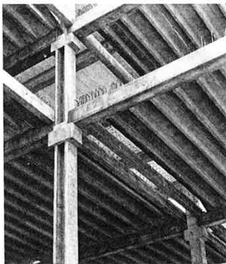
Fig 17. Den U-formade pelaren döljer och skyddar vertikala installationer. Öppningen täcks med en täckplatta (Strängbetong).
