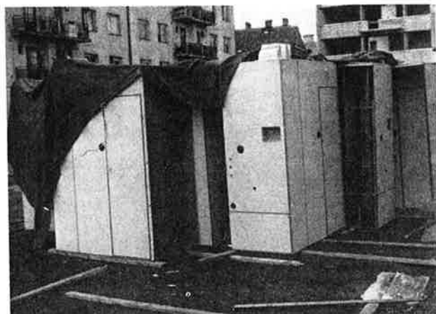
Fig 4. Installationsblock med beklädnad av plastlaminat innehållande rörledning för kök och badrum (Tjeckoslovakien).
