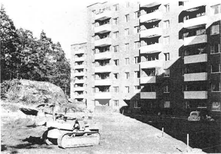
Arbete med en parkeringsplats pågår. Till vänster syns den höga kulle som påverkat planutformningen.
