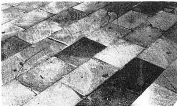
Fig. 4. Detalj av nedfuktat kubbgolv med skumplastfyllda fogar. Svällningsmöjligheten är utnyttjad och skumplasten helt hoptryckt
