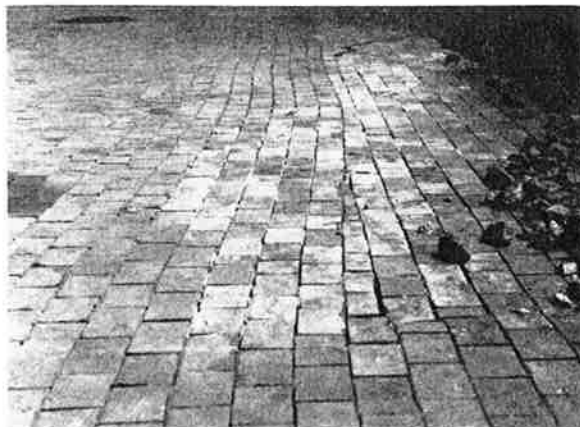
Fig. 6. Sedan ASEA-golvet legat helt dränkt i vatten under fyra dygn slog en bula upp på cirka 10 m 2 yta längs ena väggen. På denna del måste kubben sältas om. Bilden visar golvet efter reparation med det omlagda partiet till höger
