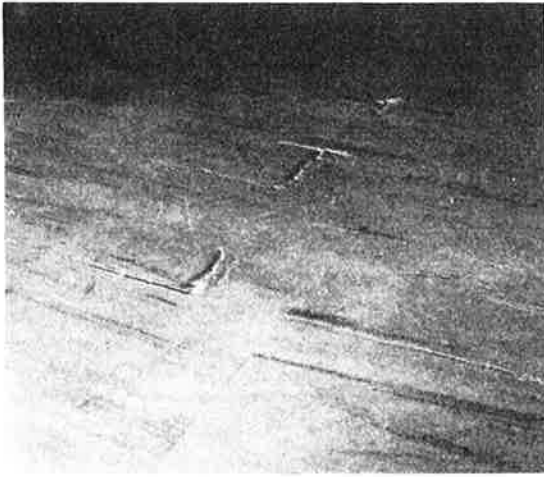
Fig. 8. Hartsplattor bryts sönder om de läggs på ett fjädrande träundergolv. I detta fall var brädernas tvärskarvar inte understödda, vilket förvärrade skadan.
