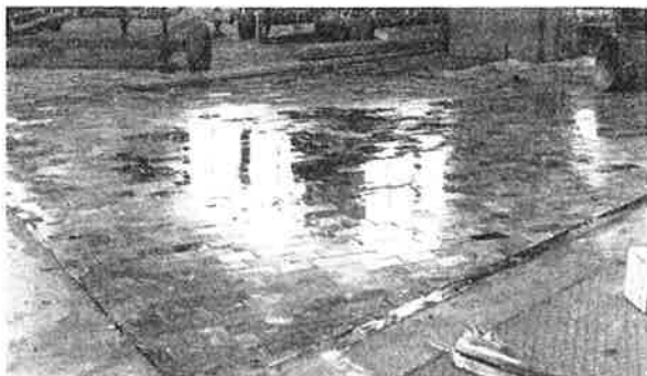
Fig. 5. På ett golv i full skala (80 m 2 ) på ASEA i Västerås hälldes i genomsnitt 2 l vatten per m 2 ut på ytan utan att skador uppstod
