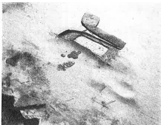
Fig. 1. Genomgjuten linoleum, skadad av fukt i undergolvet. Linoleummassan hade lossnat från väven, svällt och bildat blåsor. När väven skars bort kom klisterblandat vatten till synes. Vid läggningstillfället hade undergolvet verkat torrt på ytan.
