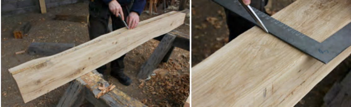
Figur 19. T.v. Uttag av fotträets mittpunkt. T.h. Därifrån utsättning av brunnskarets yttermått med timmermansvinkel och rits.
