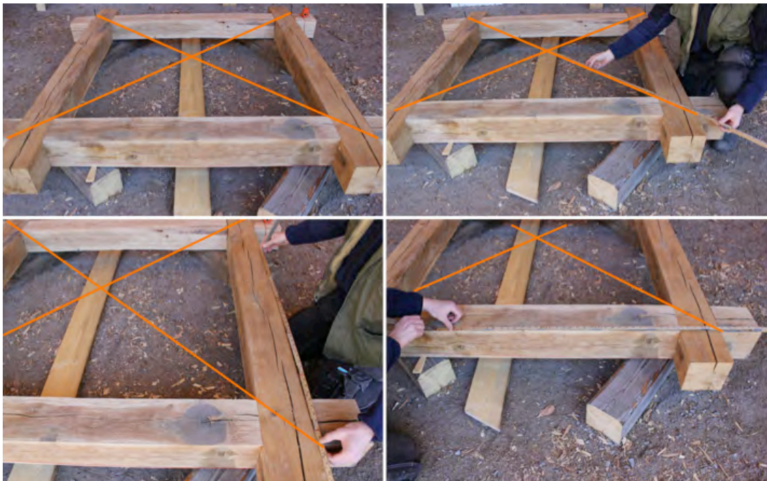
Figur 27. Ett snöre spändes upp mellan knutarnas utsidor som skapade diagonaler i fotträramen. I figur har snöret förstärkts med orangea linjer. Avståndet – halv diagonalen, från krysset i mitten till ytterkant fotträramen tags ut med tumstock. Avståndet fördes över och markerades på fotträet för ett hörn som figuren visar. Proceduren upprepades för alla fyra hörnen. Dessa markeringar bands sedan samman och bildade en åttkantig form med lika stora sidor, se Figur 28.
