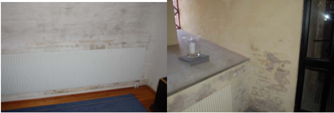
Figur 13 och 14 : Fuktskadad vägg i långhuset samt vapenhuset, 2013-04-25
