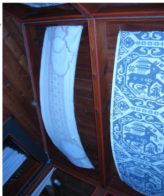
Fig. 16. Fukt- och vattenskadorna, tapetvåder i Lillstugan
