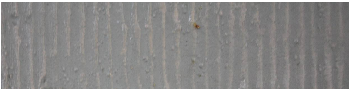
Bild 2 Närbild gördellist före färgundersökning. Färgskiktet på den lågerhuggna listen var i dåligt skick.
