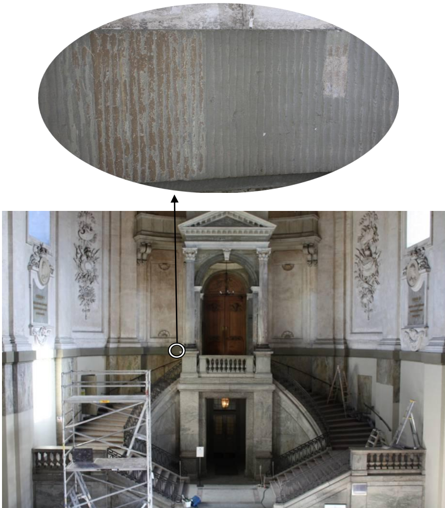
Bild 9 Färgrappa och framskrapat färgfält på östra väggen i relation till södra valvet.
