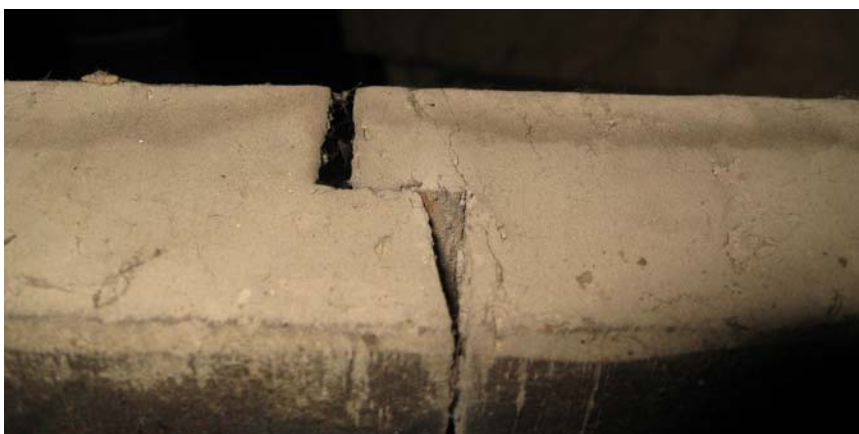
Figur 4. Närbild av falsen mellan dörrplankorna.
