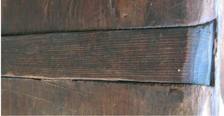
Figur 13. Narorna har stående eller diagonalt ställda årsringar.
